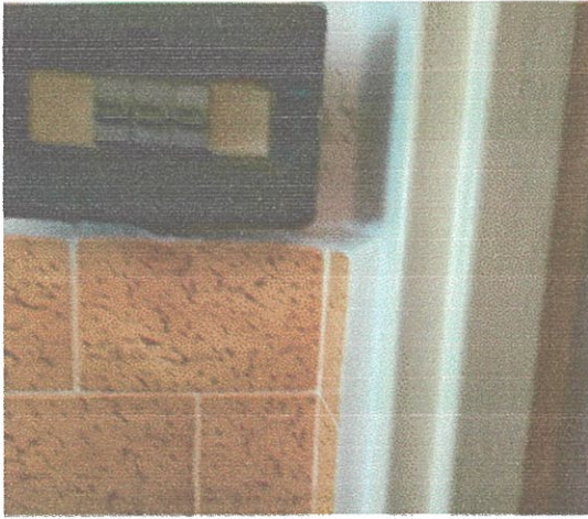
Nieczynna skrzynka do demontażu w pom. łazienki
