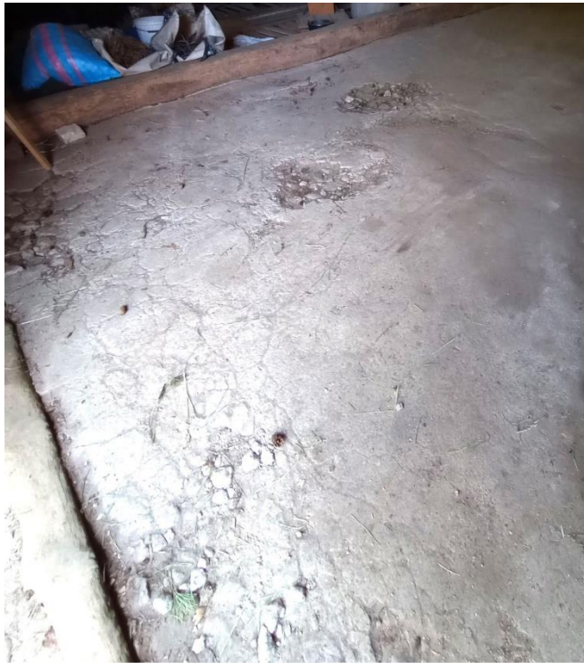
Fot. 9 Budynek stodoły – posadzka
