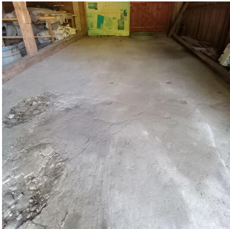
Fot. 8 Budynek stodoły – posadzka
