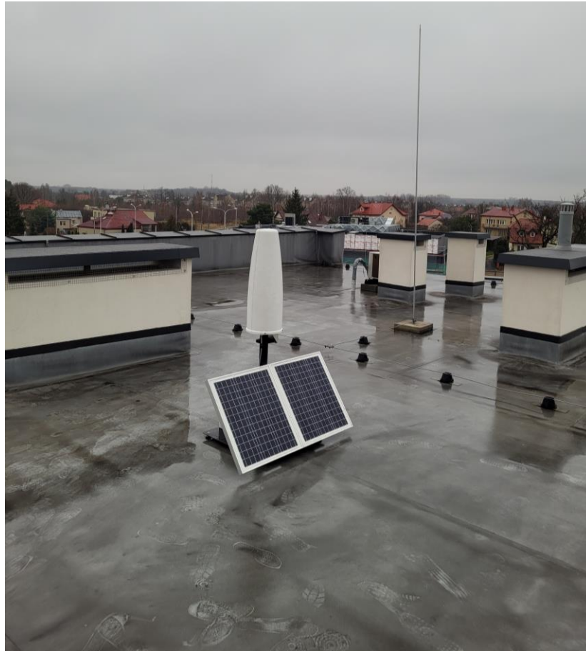
Rys. 2 Miejsce montażu SELMS PEM – dach Szkoły Podstawowa nr 404
