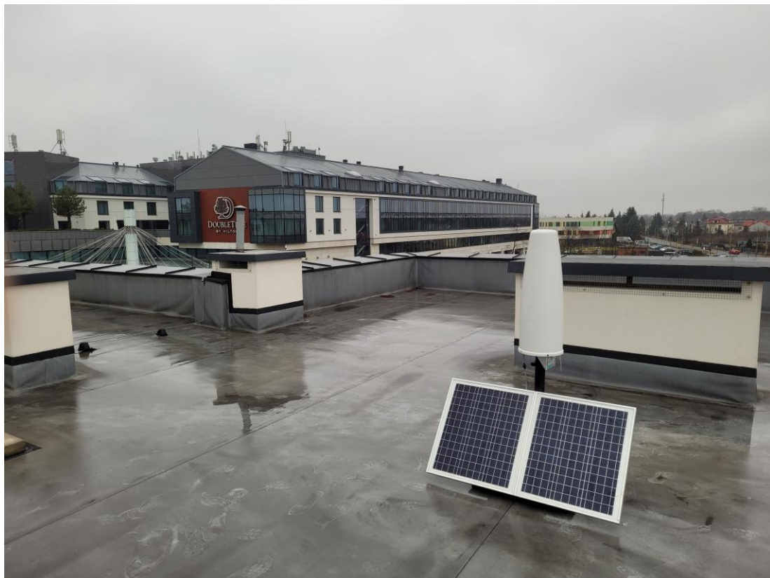
Rys. 3 Miejsce montażu SELMS PEM – Szkoła podstawowa nr 404, widok na anteny SBTk
