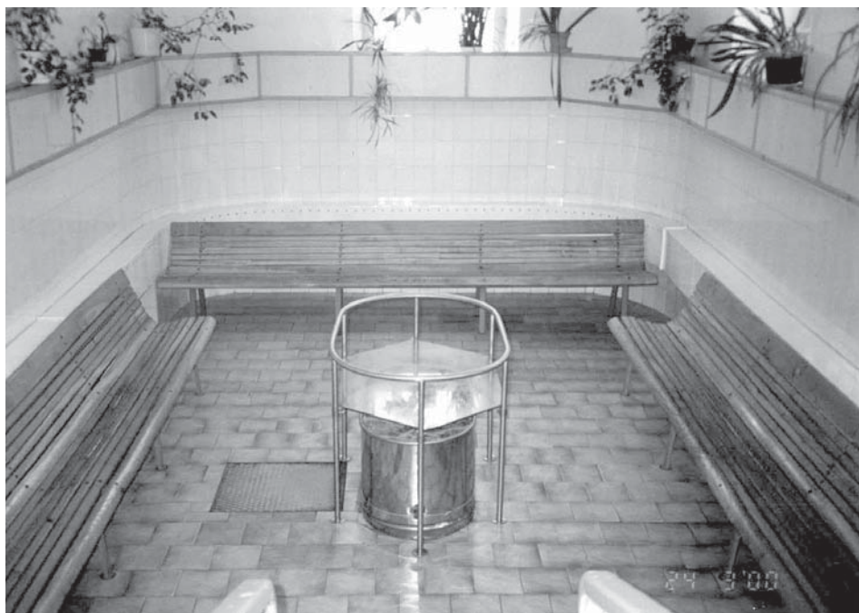
Rys. 3.13. Pomieszczenie zbiorowych suchych kąpielii \text{CO}_2 w Starych Łazienkach Mineralnych w Krynicy Zdroju (fot. Wojciech Ciężkowski).
