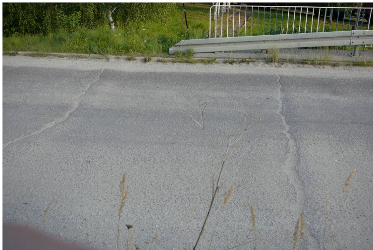
Rys. 6-22. Uszkodzenia nawierzchni jezdni na dojazdach do mostu (obniżenia, deformacje, rysy, pęknięcia) spowodowane nieprawidłową pracą (lub brakiem) płyty przejściowej
