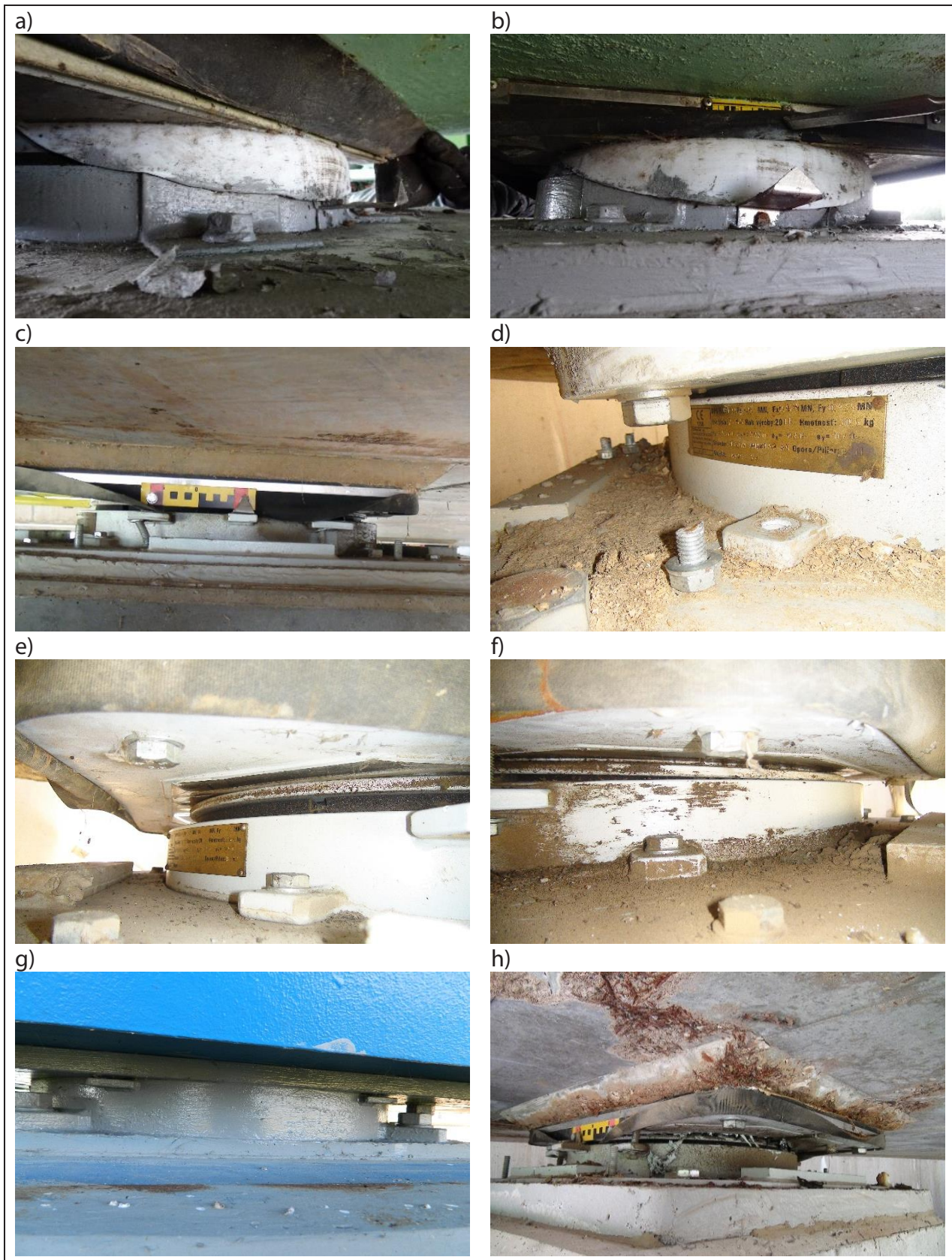
Rys. 6-15. Wybrane, typowe uszkodzenia łożysk garnkowych: a, b) wyciśnięty teflon spowodowany przeciążeniem łożyska, c) przekroczenie zakresu przesuwu w łożyskach, d) ścięcie zakotwień garnka łożyska stałego do ciosu spowodowane przekroczeniem zakresu przesuwu, e) deformacja płyty górnej spowodowana przekroczeniem zakresu przesuwu, f) nierównomierne wciśnięcie tłka łożyska spowodowane przekroczeniem zakresu przesuwu, g) całkowite wciśnięcie tłka w garnek spowodowane przeciążeniem łożyska, h) uszkodzenia łożyska spowodowane złą jakością betonu przęśła w pobliżu podparcia
