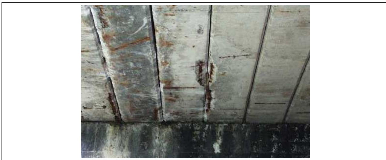
Rys. 6-7. Przecieki na styku belek prefabrykowanych świadczące o uszkodzeniu izolacji pomostu; skutkiem przecieków jest degradacja materiału prefabrykatów
