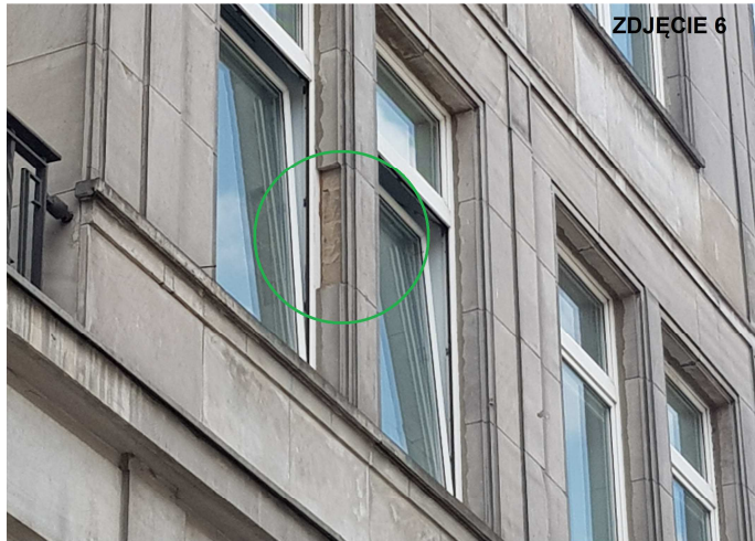
— UBYTKI GLIFÓW / POPRAWA MOCOWANIA GLIFÓW OKIENNYCH
