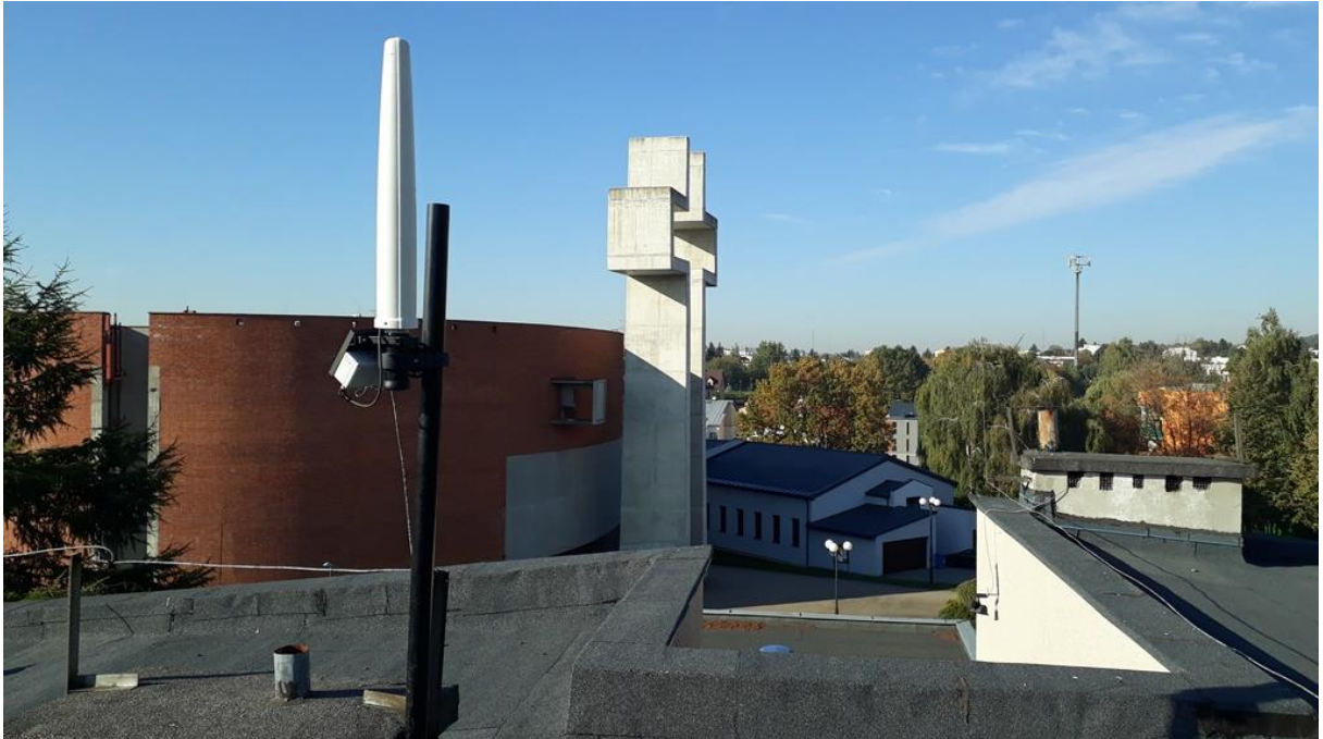
Rys. 2 Miejsce montażu SMS PEM – dach Przedszkola nr 45, Lublin – widok na maszt z antenami SBTK
