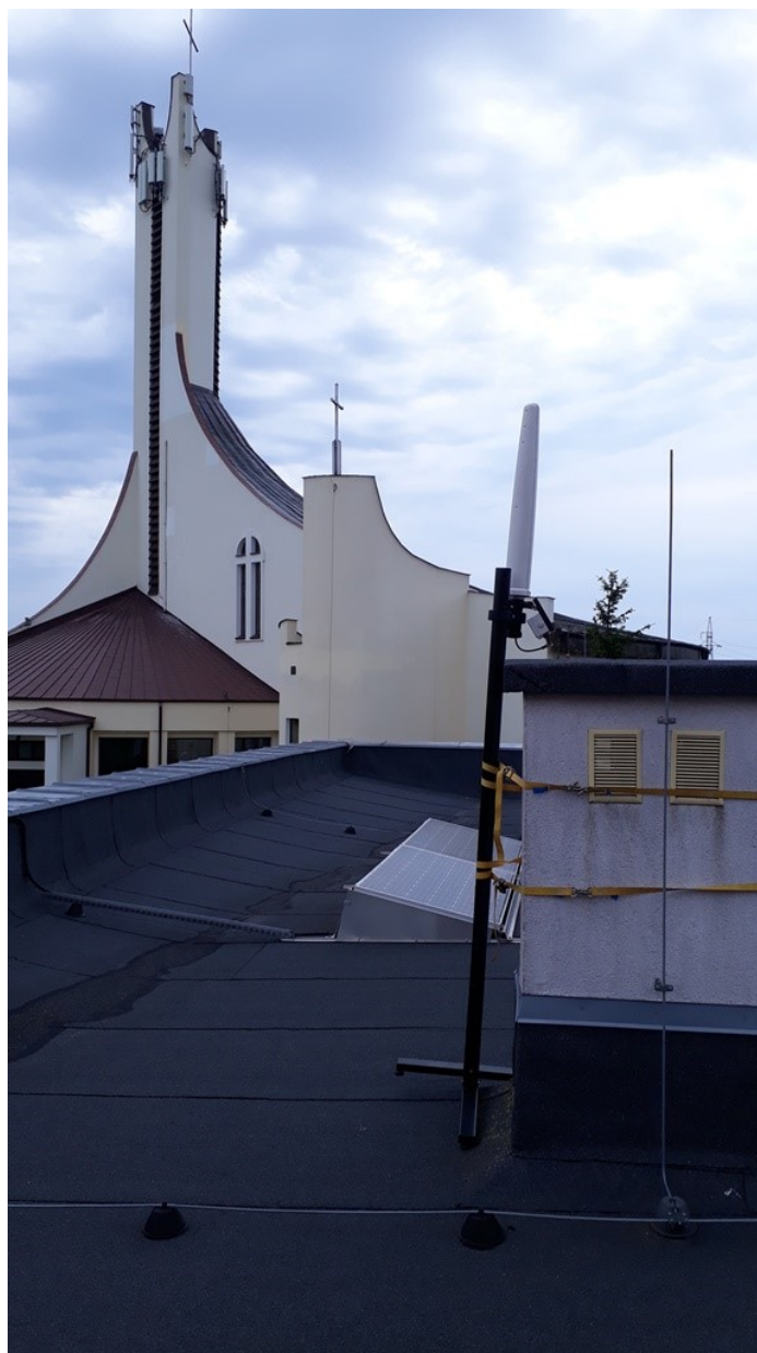
Rys. 3 Miejsce montażu SMS PEM – Szkoła Podstawowa nr 24 w Płocku – widok na SBTk
