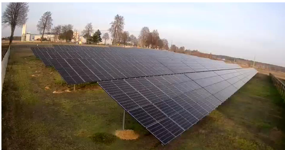
Fot. 9. WFOŚiGW w Łodzi współfinansuje inwestycje, które w znaczącym stopniu wpływają na poprawę stanu środowiska w województwie łódzkim. Jedną z takich inwestycji jest elektrownia fotowoltaiczna Kozenin oddana do użytku w 2022 r.
