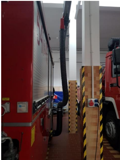
Fot. 1 Wyciąg spalin na garażu C
