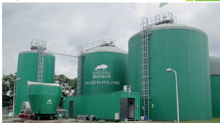
Biogazownia w Przybrodzie, Uniwersytet Przyrodniczy w Poznaniu, Fot. Agnieszka Staniszevska
