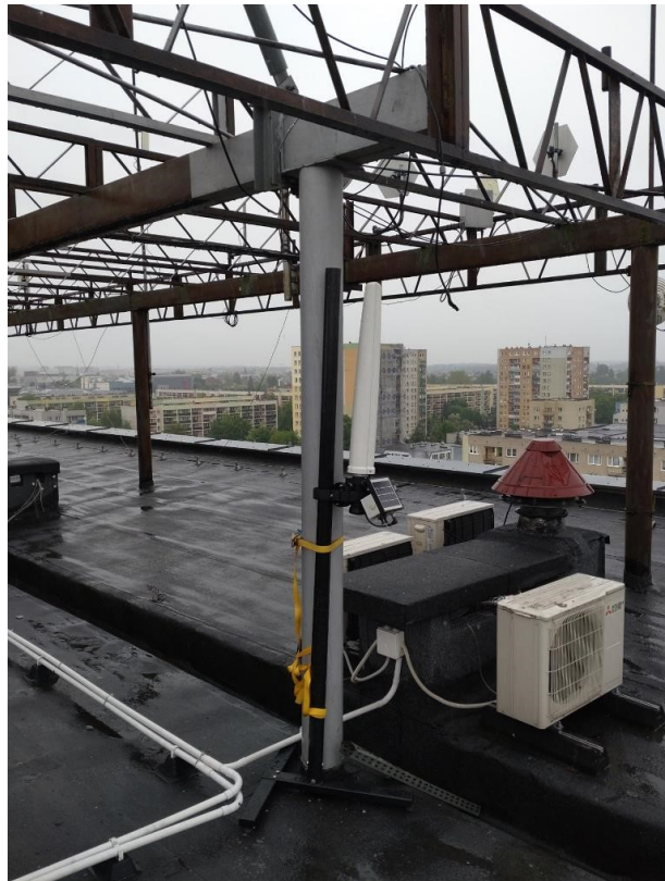
Rys. 3 Miejsce montażu SMS PEM – dach Zespołu Szkół w Suwałkach
