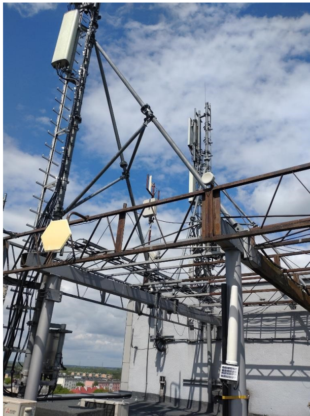
Rys. 4 Miejsce montażu SMS PEM – Zespół Szkół w Suwałkach – widok na SBTK
