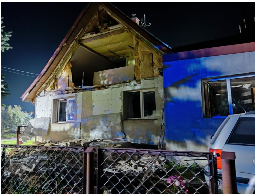
Fot. 7 17.09.2023 r. – Pożar budynku dwurodzinnego z magazynem energii Bytów
