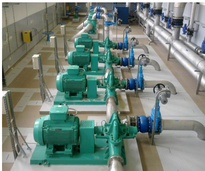
Hala pomp ujęcia wody w Trębowcu
