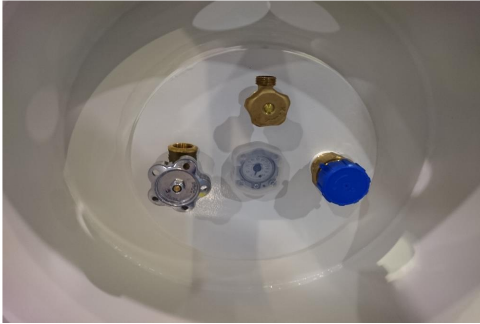
Rys. 7. Przyłącza zbiornika magazynowego.
