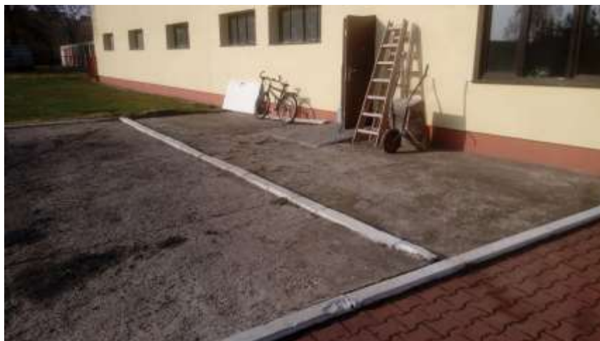
A tak wyglądało stanowisko do mycia pojazdów przed remontem....
