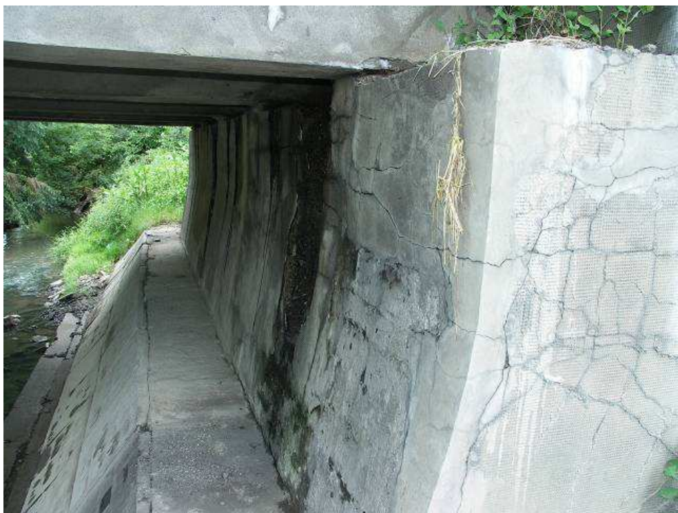
Fot. 25. Uszkodzenia podpory nr 2 od strony góry rzeki: rysy, zacieki, wykwyty, ubytki betonu spowodowane złą jakością betonu, niewłaściwym odwodnieniem obiektu i zaniedbaniami w utrzymaniu
