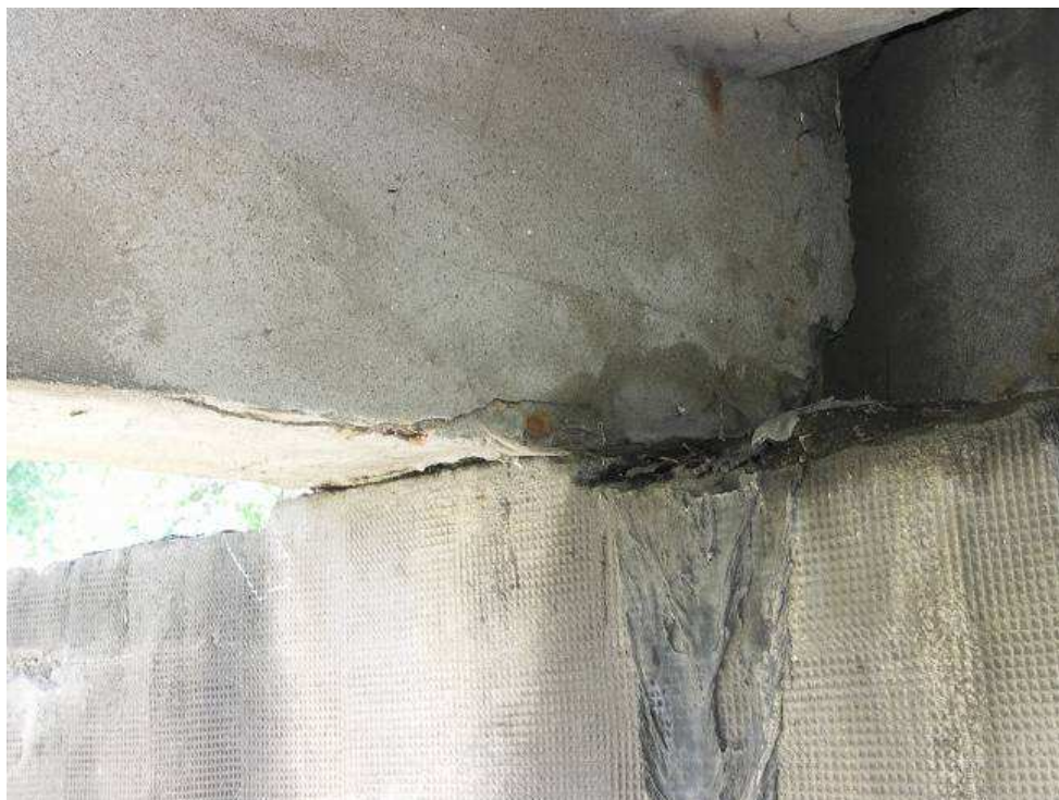
Fot. 12. Uszkodzenia dźwigara nr 5 w pobliżu podpory nr 1 – korozja zbrojenia, zarysowania, ubytki betonu i zawilgocenia spowodowane przeciekami przez szczelinę dylatacyjną. Ubytki betonu w ławie podłożyskowej
