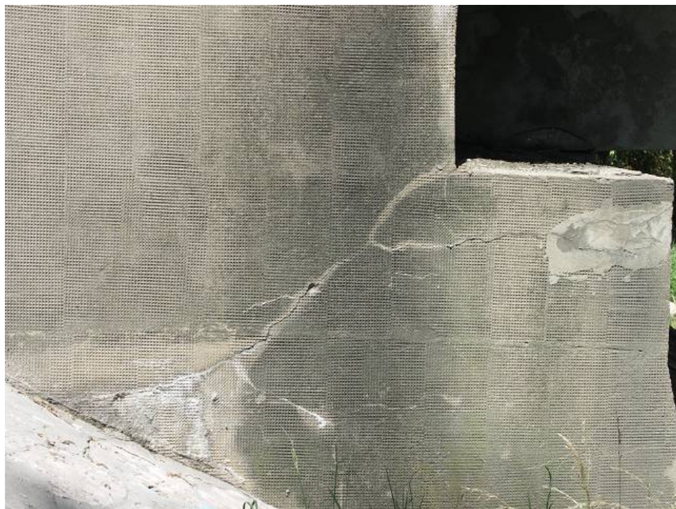
Fot. 20. Rysy na prawym skrzydle podpory nr 1 (zbliżenie) spowodowane zablokowaniem szczeliny dylatacyjnej i/lub zbyt słabym zbrojeniem skrzydełka
