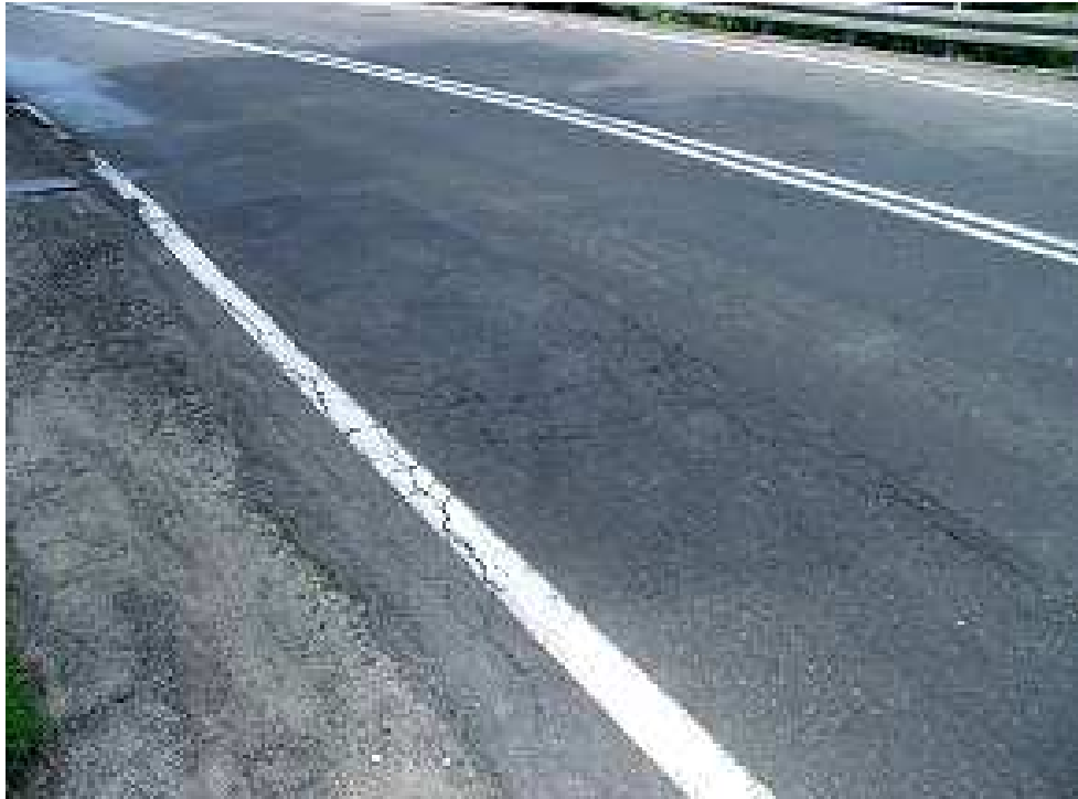
Fot. 7. Rysy i pęknięcia w nawierzchni jezdni spowodowane złą jakością wykonania, starzeniem materiału i intensywną eksploatacją
