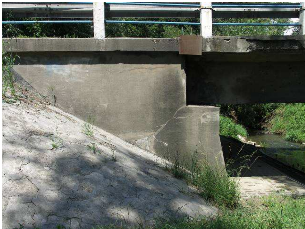
Fot. 19. Uszkodzenia prawego skrzydła (od strony góry rzeki) podpory nr 1. Widoczne są rysy, ubytki betonu i zacieki a także osunięcie stożka nasypu i roślinność na obrukowaniu stożka.
