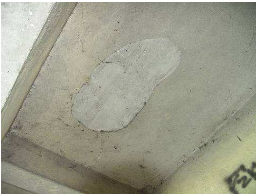
Fot. 15. Ubytki wyprawy od spodu płyty pomostu, między dźwigarami 1 i 2, spowodowane złą jakością wykonania
