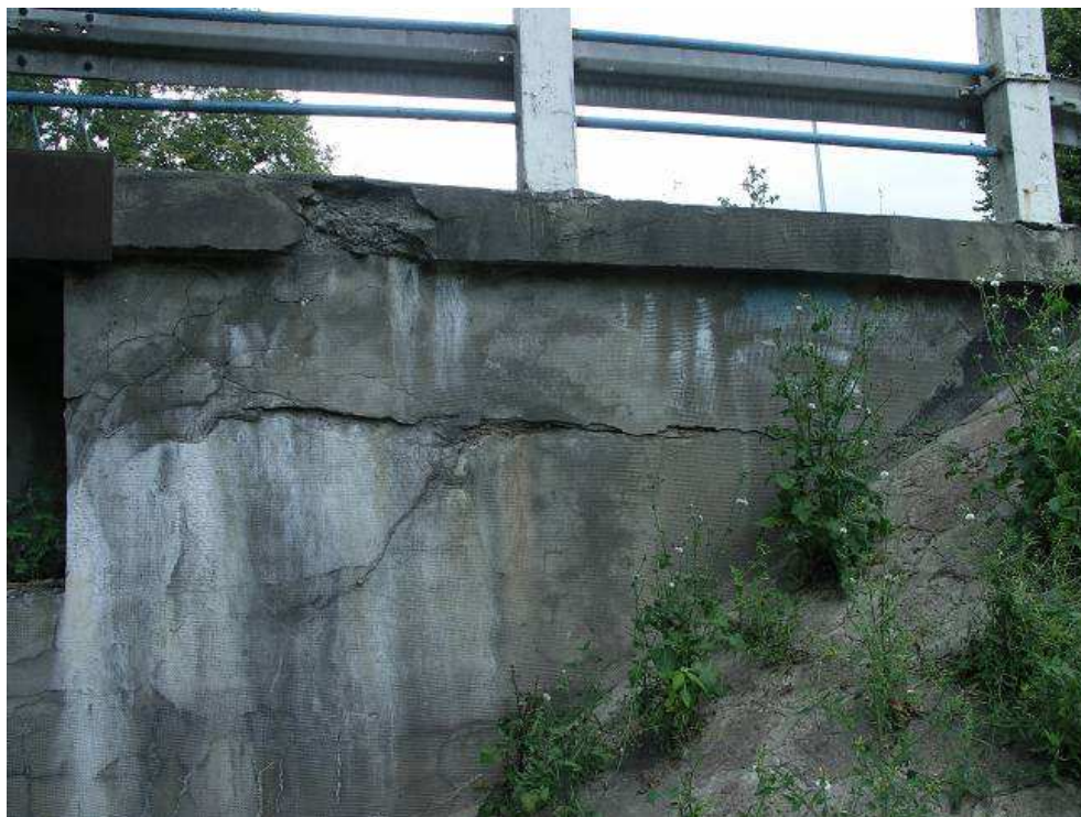
Fot. 22. Pęknięcie prawego skrzydła podpory nr 2 (od strony góry rzeki) spowodowane złą jakością wykonania obiektu, brakiem łożysk ruchomych i nieprawidłowym odwodnieniem obiektu. Wegetacja roślin na obrukowanym stożku nasypu
