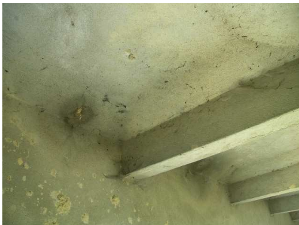
Fot. 16. Przecieki przez płytę pomostu w osi ścieku spowodowane uszkodzeniem izolacji
