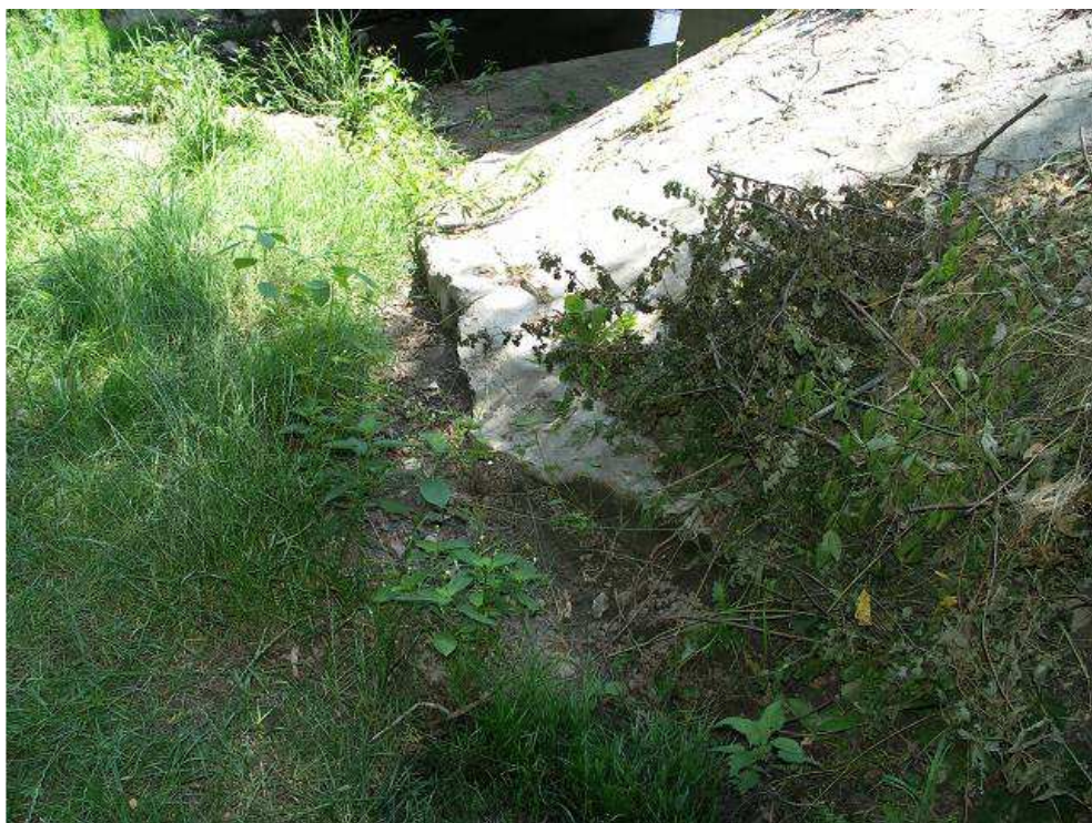
Fot. 26. Erozja gruntu u podnóża stożka przy podporze nr 1 od strony dołu rzeki. Zanieczyszczenie umocnienia stożka
