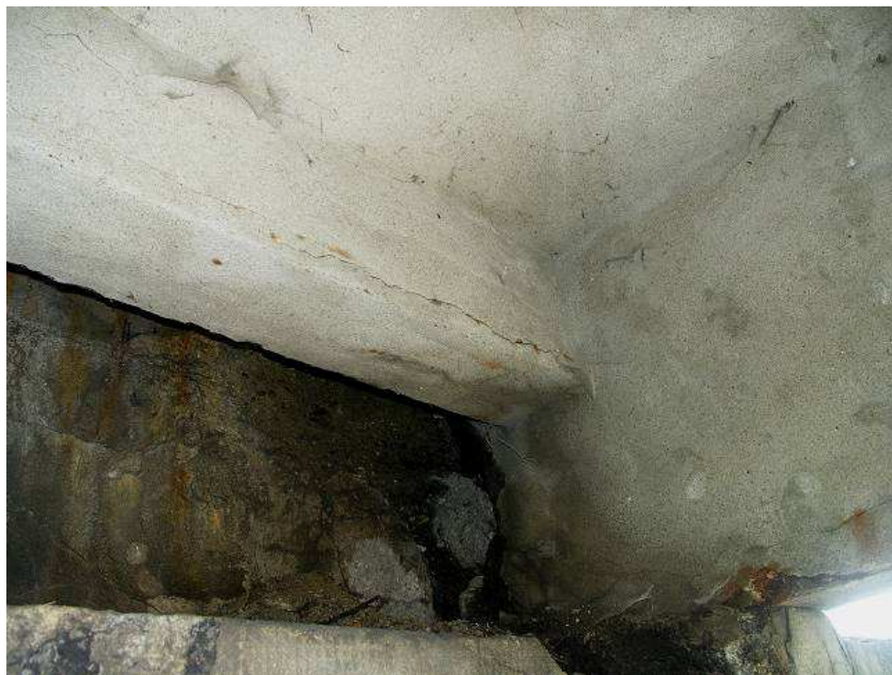
Fot. 14. Rysa na poprzecznicy nad podporą nr 2, między dźwigarami 4 i 5, spowodowana korozją prętów zbrojeniowych
