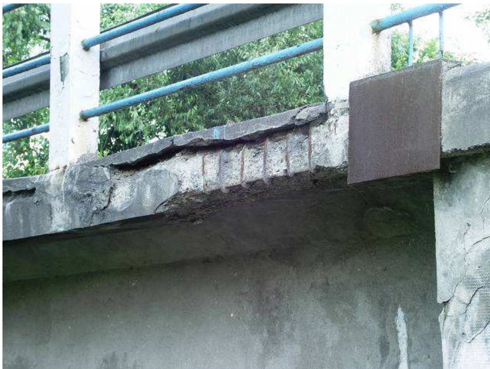
Fot. 18. Uszkodzenia belki podporęczowej po prawej stronie mostu spowodowane złą jakością betonu i zaniedbaniami w utrzymaniu. Widoczne ubytki betonu, odsłonięte, skorodowane zbrojenie
