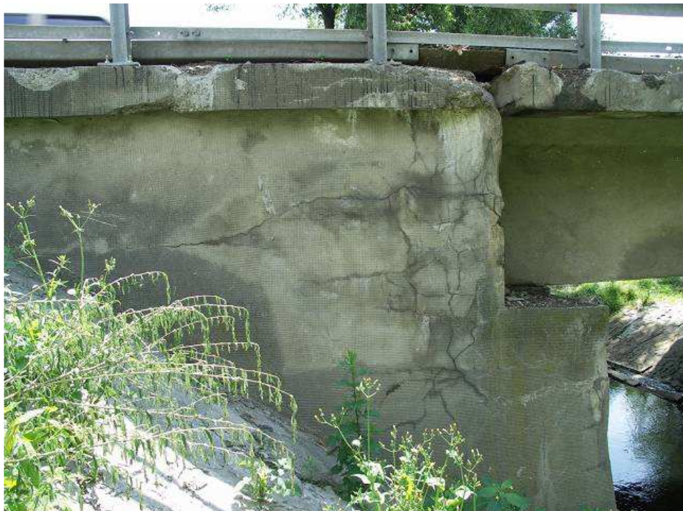
Fot. 23. Zarysowanie i pęknięcia lewego skrzydła podpory nr 2, ubytki i korozja spowodowane złą jakością betonu oraz zaniechaniami w utrzymaniu. Bujna roślinność na stożkach nasypu
