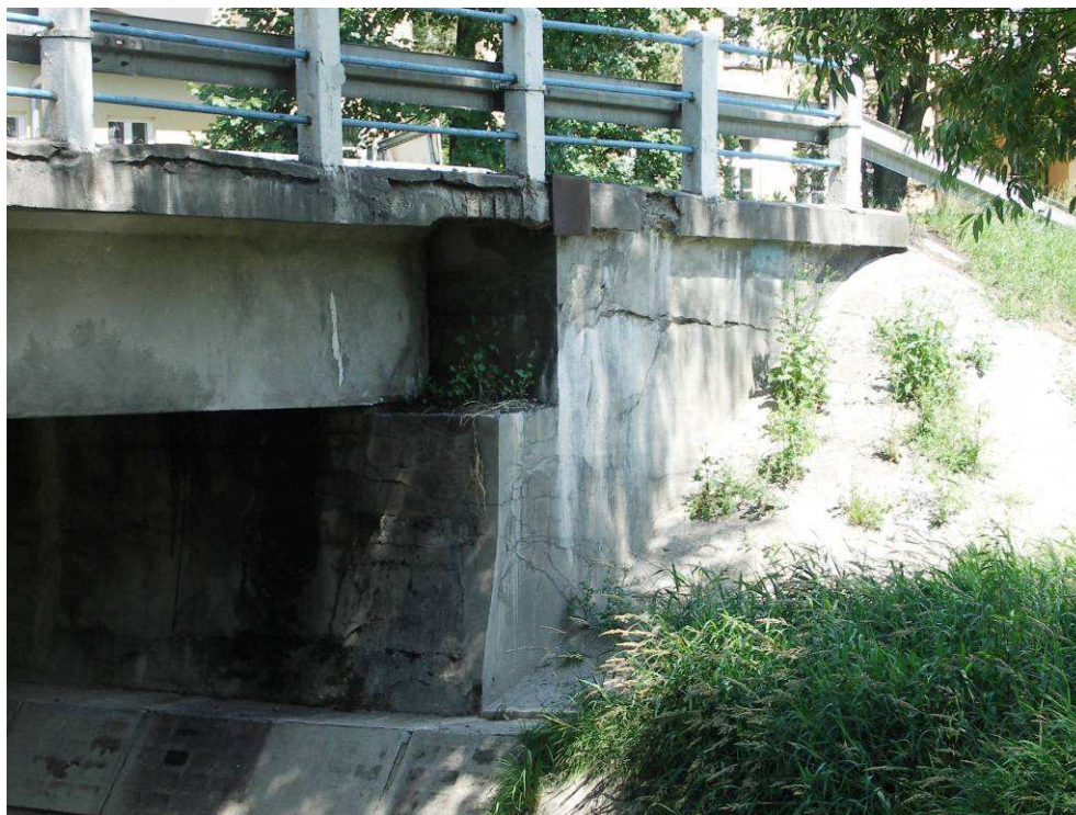
Fot. 21. Uszkodzenia podpory nr 2 – widok od strony góry rzeki. Zarysowania, pęknięcia, ubytki i korozja betonu. Wegetacja roślin na ławie podłożyskowej i obrukowanym stożku nasypu
