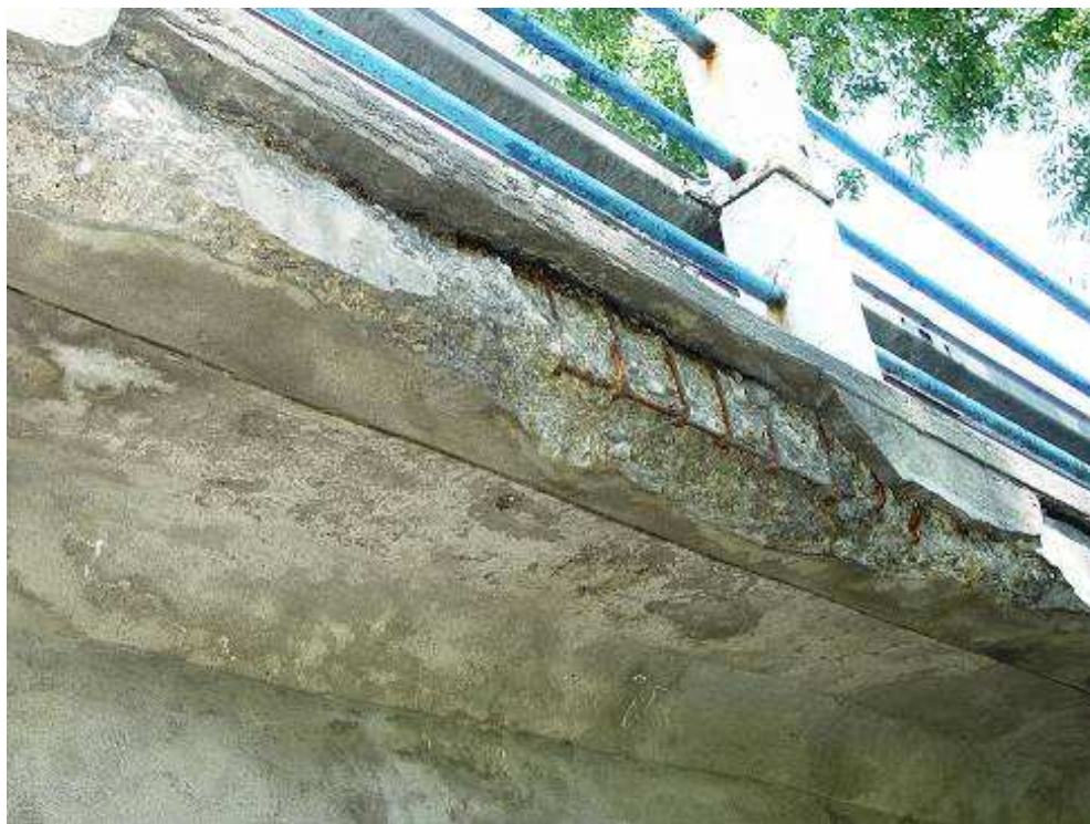
Fot. 17. Ubytki betonu, odsłonięte skorodowane zbrojenie, zacieki i wykwyty na prawym wsporniku podchodnikowym. Uszkodzenia są wynikiem złej jakości betonu, niedbałym wykonaniem obiektu i brakiem odpowiednich zabiegów utrzymaniowych
