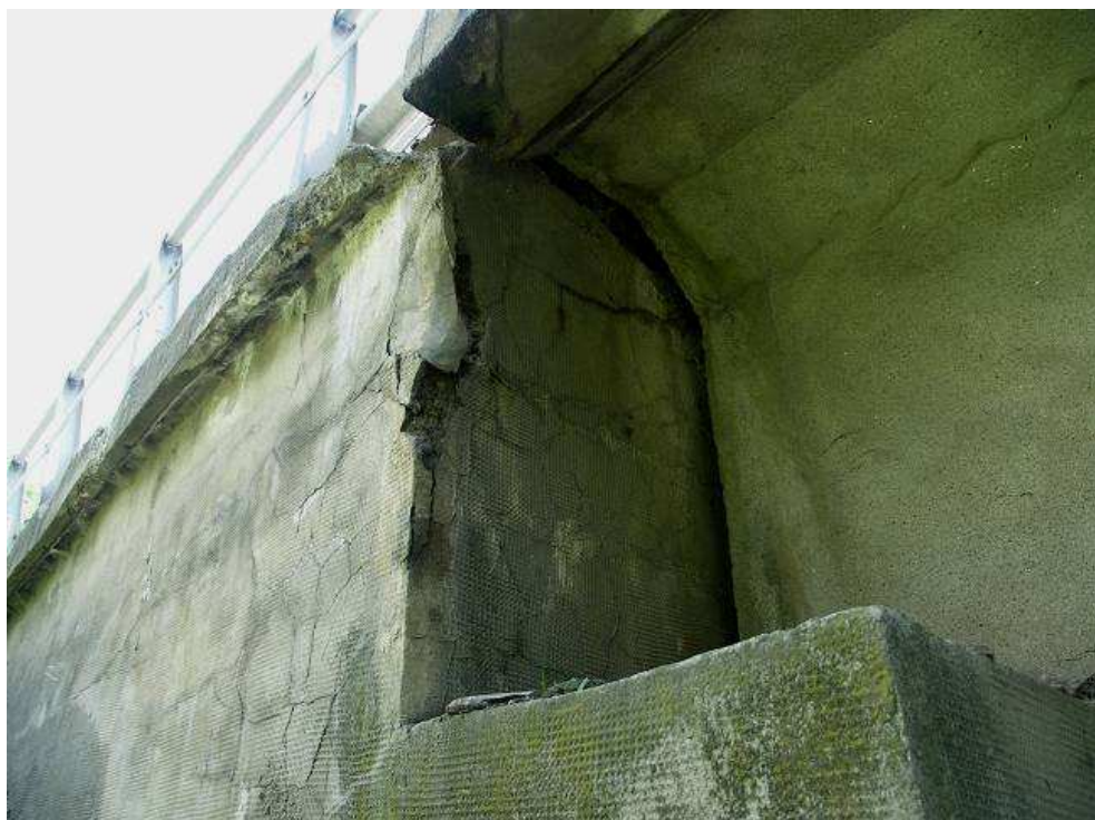
Fot. 24. Zarysowania, pęknięcia i ubytki betonu lewego skrzydła i ścianki żwirowej podpory nr 2 spowodowane przede wszystkim złą jakością betonu
