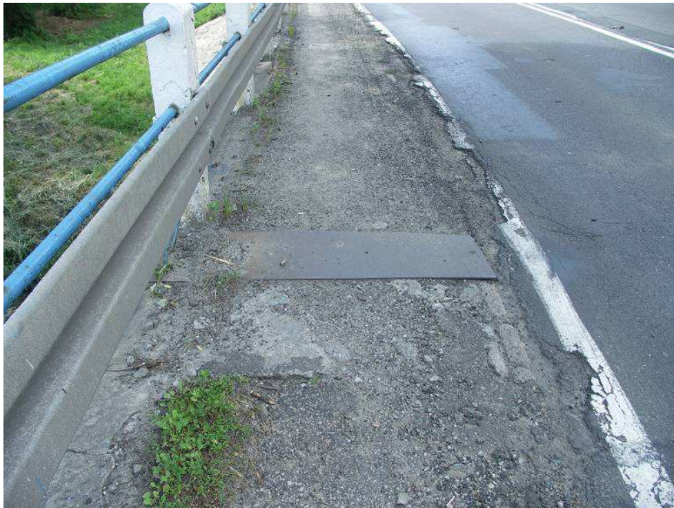
Fot. 8. Zanieczyszczenia, korozja betonu i wegetacja roślin na lewostronnym poboczu spowodowane niewłaściwym utrzymaniem obiektu i brakiem odpowiednich spadków poprzecznych i ścieku. Ubytki nawierzchni na krawędzi jezdni.
