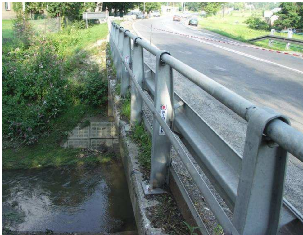
Fot. 10. Wegetacja roślin i zanieczyszczenia na belce podporęczowej po lewej stronie mostu spowodowane brakiem systematycznych prac utrzymaniowych
