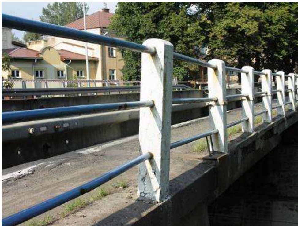
Fot. 9. Uszkodzenia balustrady po prawej stronie mostu – złuszczenia farby na słupkach, rdzawe zacieki i zarysowania w miejscu połączenia słupków z konstrukcją przęsła. Korozja powłoki malarskiej spowodowana m.in. stosowaniem środków odładzających w okresie zimowym
