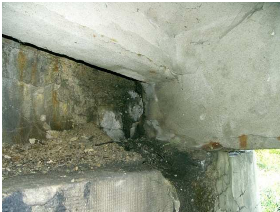
Fot. 11. Uszkodzenia dźwigara nr 5 w pobliżu podpory nr 2 – korozja zbrojenia, korozja i ubytki betonu spowodowane przeciekami wody przez nieszczelną dylatację, ubytki betonu i zanieczyszczenia ławy podłożyskowej. Ubytki, zarysowania i korozja betonu korpusu przyczółka
