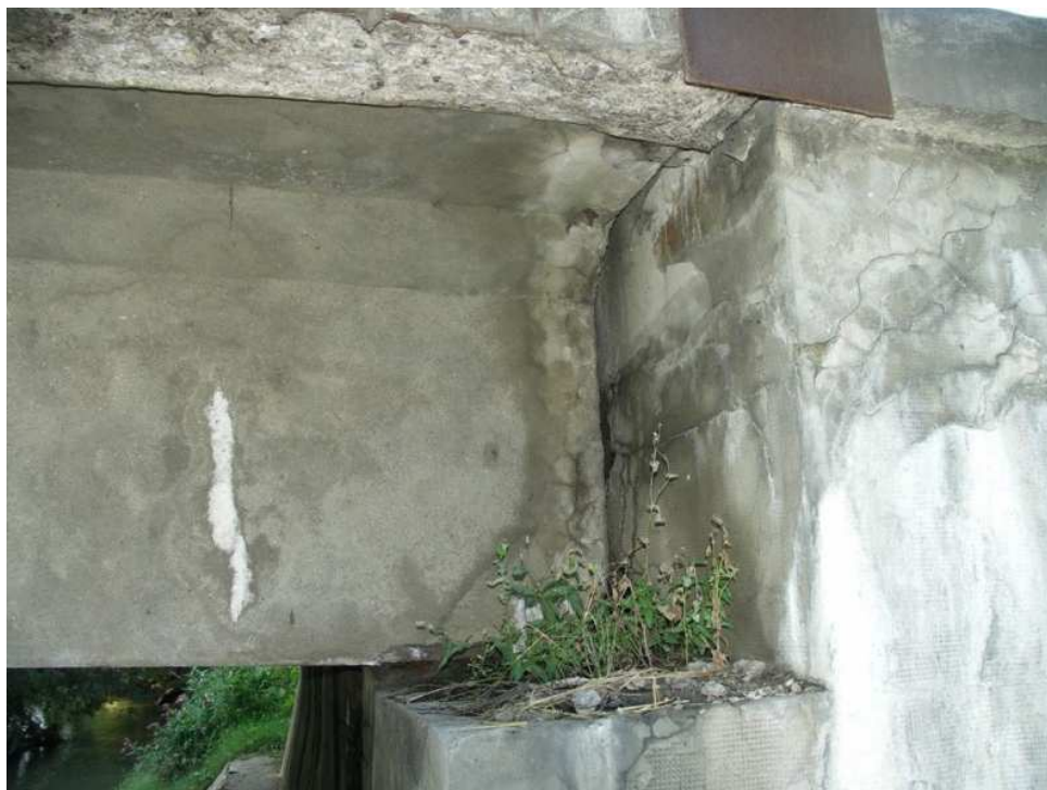
Fot. 13. Uszkodzenia dźwigara nr 5 w sąsiedztwie podpory nr 2 – wykwyty na bocznej powierzchni, zarysowania, ubytki i korozja betonu na krawędzi dźwigara spowodowana przeciekami wody przez szczelinę dylatacyjną. Zarysowania i korozja betonu przyczółka. Zanieczyszczenia i wegetacja roślin na ławie podłożyskowej
