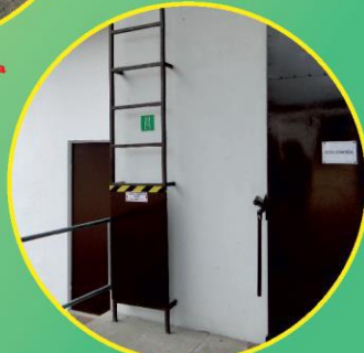
Ochrona przed wejściem na schody osób postronnych i dzieci.
