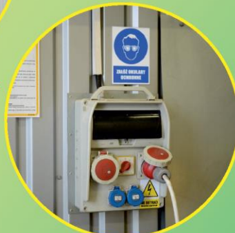
Prawidłowo wykonana i oznakowana instalacja elektryczna.
