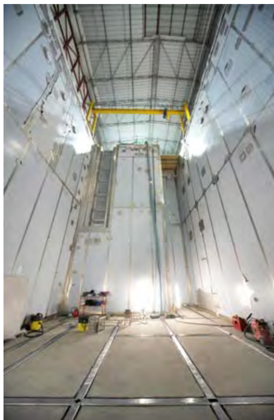
Rys. 7. Budynek paliwowy: basen do przechowywania prętów z wypalonym paliwem z poszyciem ze stali nierdzewnej. Zdjęcie: EDF/Flamanville 3 [14]
