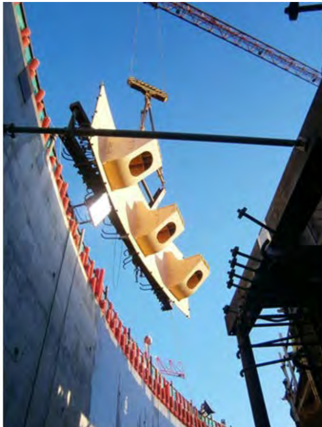
Rys. 11. Podpory suwnicy obrotowej budynku reaktora EPR we Flamanville 3. Zdjęcie: EDF/Flamanville 3 [18]
