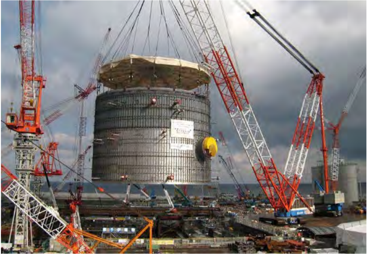
Rys. 20. Dolny pierścień cylindryczny płaszcza stalowego (RCCV Lower Liner Module) reaktora ABWR firmy GE Hitachi [27]
