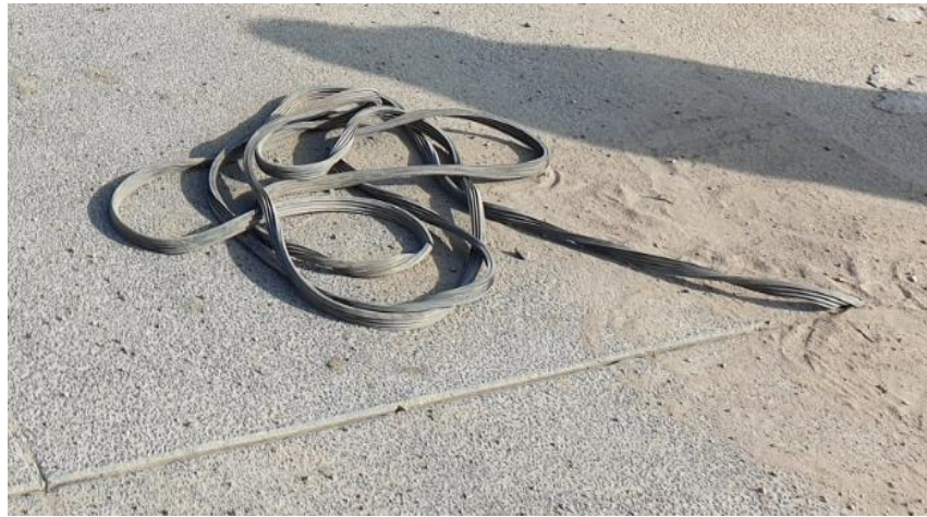
Gumowe profile uszczelniające wyciągnięte w trakcie ruchu technologicznego.
