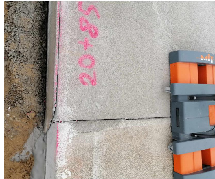
Nieprawidłowe wykończenie krawędzi na połączeniu płyt.
