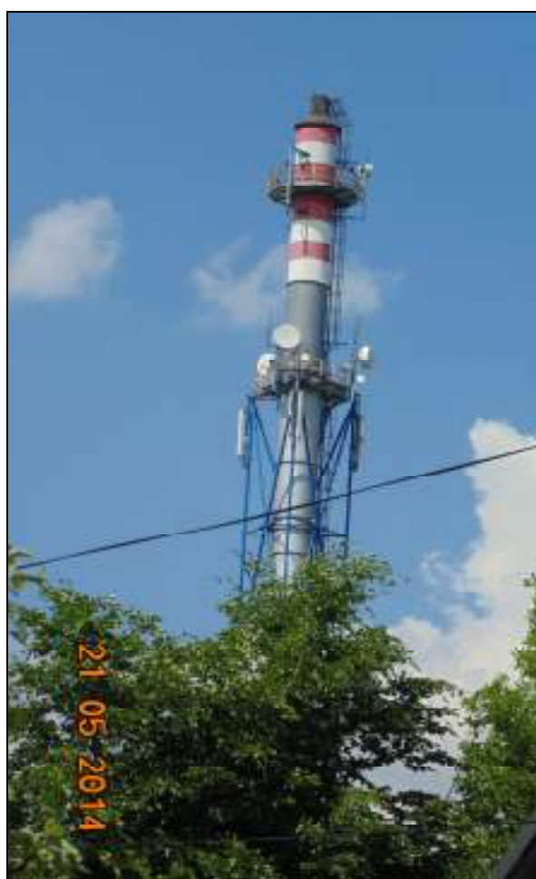
Fot. 5. Fragment instalacji radiokomunikacyjnej przy ulicy J. Tuwima
