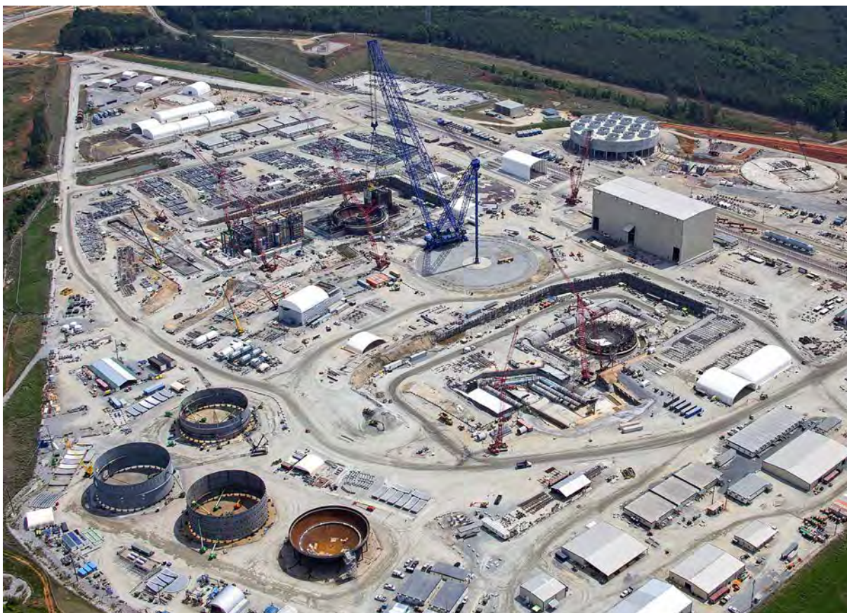
Zdjęcie: South Carolina Electric & Gas, May 2014
