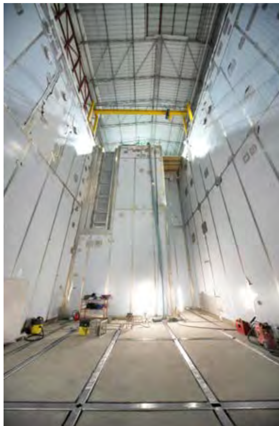
Rys. 7. Budynek paliwowy: basen do przechowywania prętów z wypalonym paliwem z poszyciem ze stali nierdzewnej. Zdjęcie: EDF/Flamanville 3 [14]
