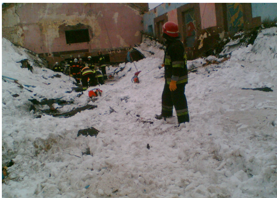
Prace poszukiwawcze przy zawalonej Hali Browaru w Gogolinie
