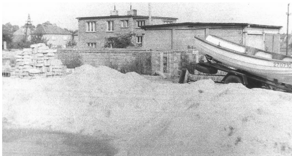
Plac budowy przyszłej remizy Zawodowej Straży Pożarnej w Krapkowicach - 1979 rok widok na dolny plac
