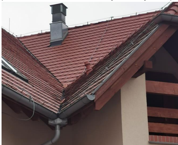
Fot. 1. Miejscowy ubytek dachówek w pokryciu dachowym. Zalegające dachówki w koszu dachowym.
