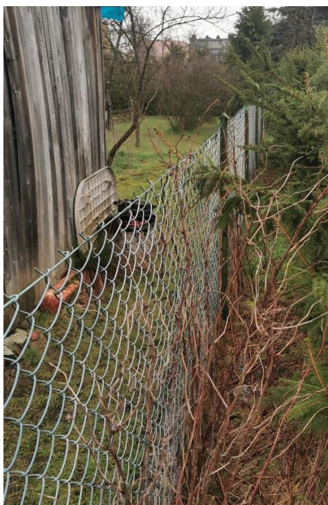
Fot. 11, 12, 13, 14, 15. Ogrodzenie przeznaczone do wymiany.
