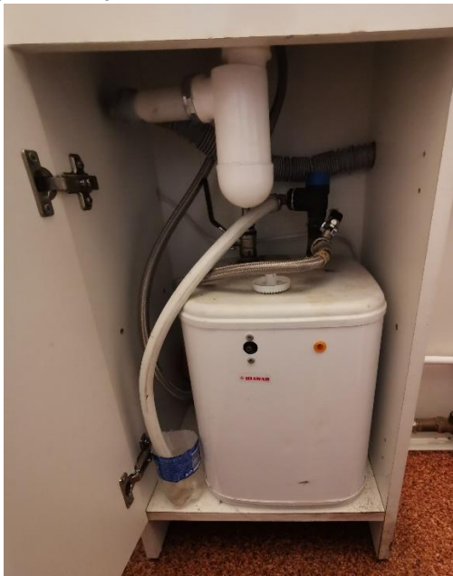
Fot. 24. Widok uszkodzonego podgrzewacza ciepłej wody użytkowej.
