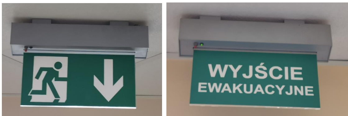
Fot. 5, 6. Widoczne oprawy ewakuacyjne wraz z akumulatorami, przeznaczone do wymiany.
