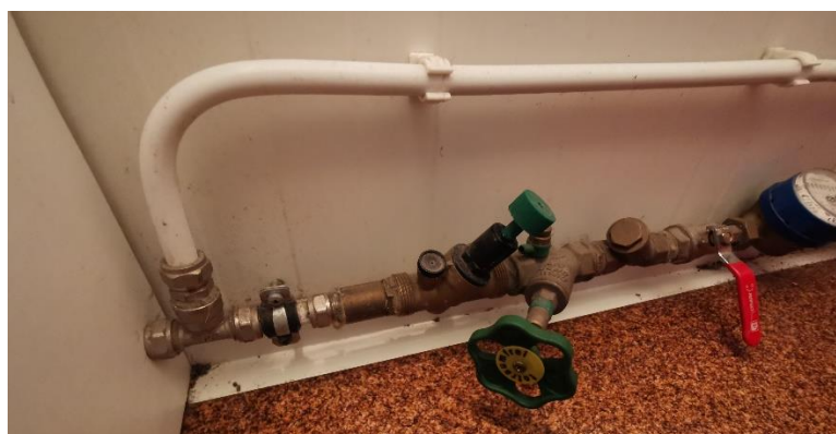
Fot. 25. Widok uszkodzonego zaworu wodnego.
