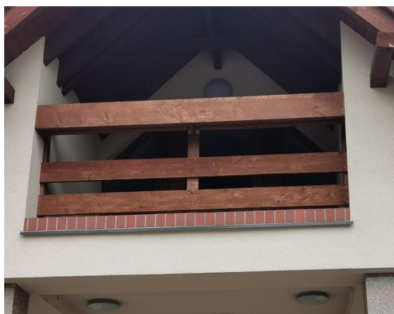
Fot. 2. Drewniana balustrada balkonu nad głównym wejście do budynku przeznaczona do malowania.
