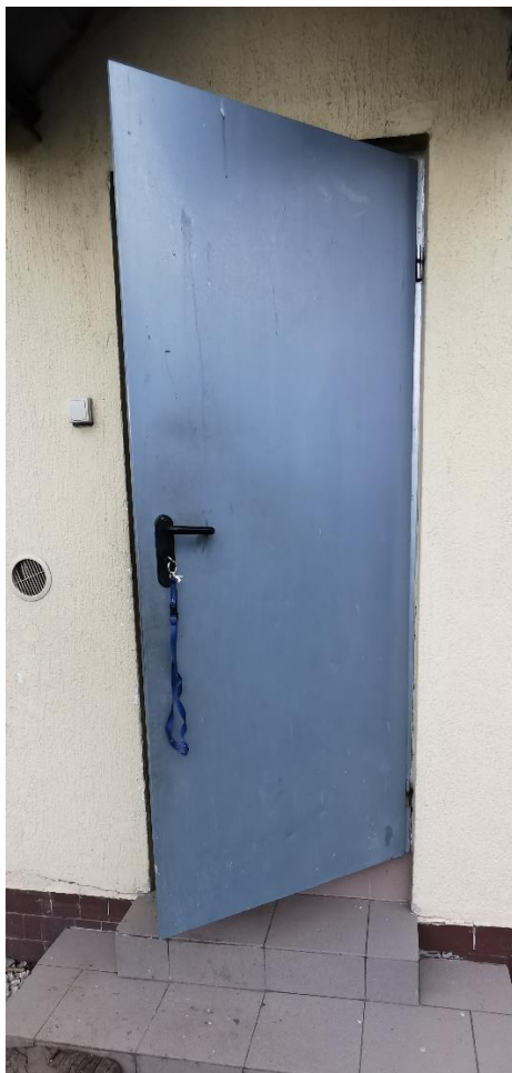
Fot. 22. Ślusarka drzwiowa zewnętrzna do kotłowni przeznaczona do wymiany.
