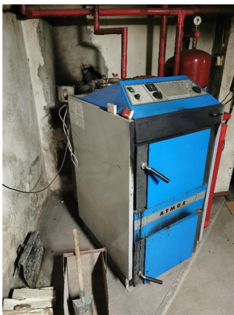
Fot. 7. Kocioł C.O. z oprzyrządowaniem przeznaczony do wymiany.
