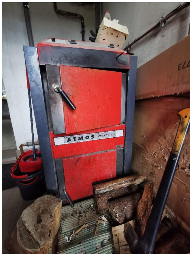
Fot. 19. Kocioł C.O. z oprzyrządowaniem przeznaczony do wymiany.
