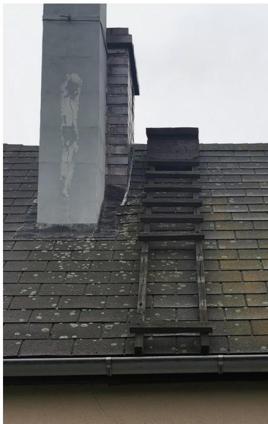
Fot. 16. Widoczne uszkodzenia drabiny dachowej.
