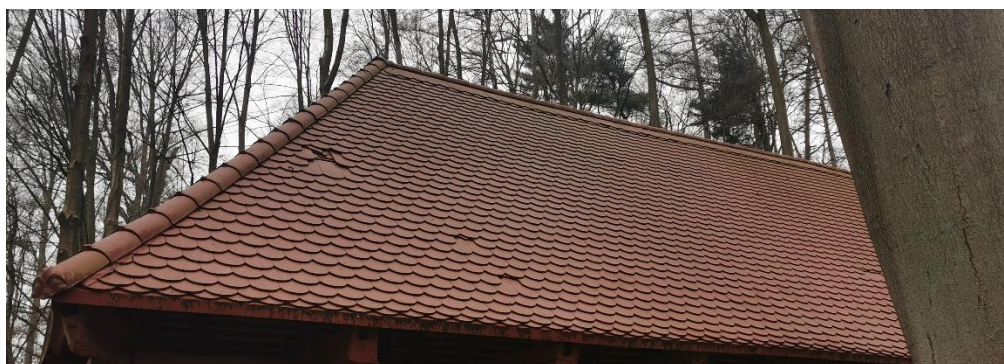
Fot. 26, 27, 28. Ubytki w pokryciu dachowym.
