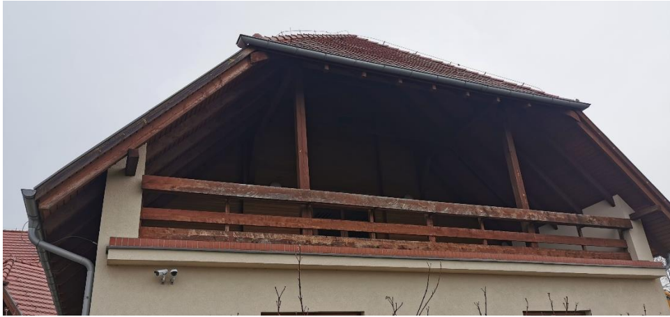
Fot. 3. Drewniana balustrada tarasu oraz zewnętrzne krokwie, murlaty i słupy przeznaczone do malowania.
