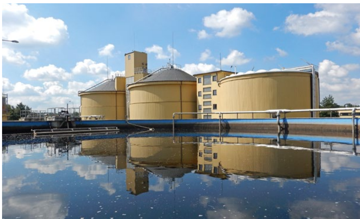
Zdjęcie 2. Komory fermentacyjne (2 x 5500 m 3 )
