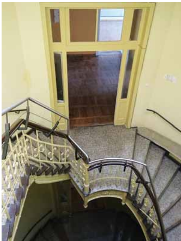
Sień budynku nr 69 przed remontem (fot. Zenon Szklarz) i po remoncie (fot. Wojciech Drąg)
