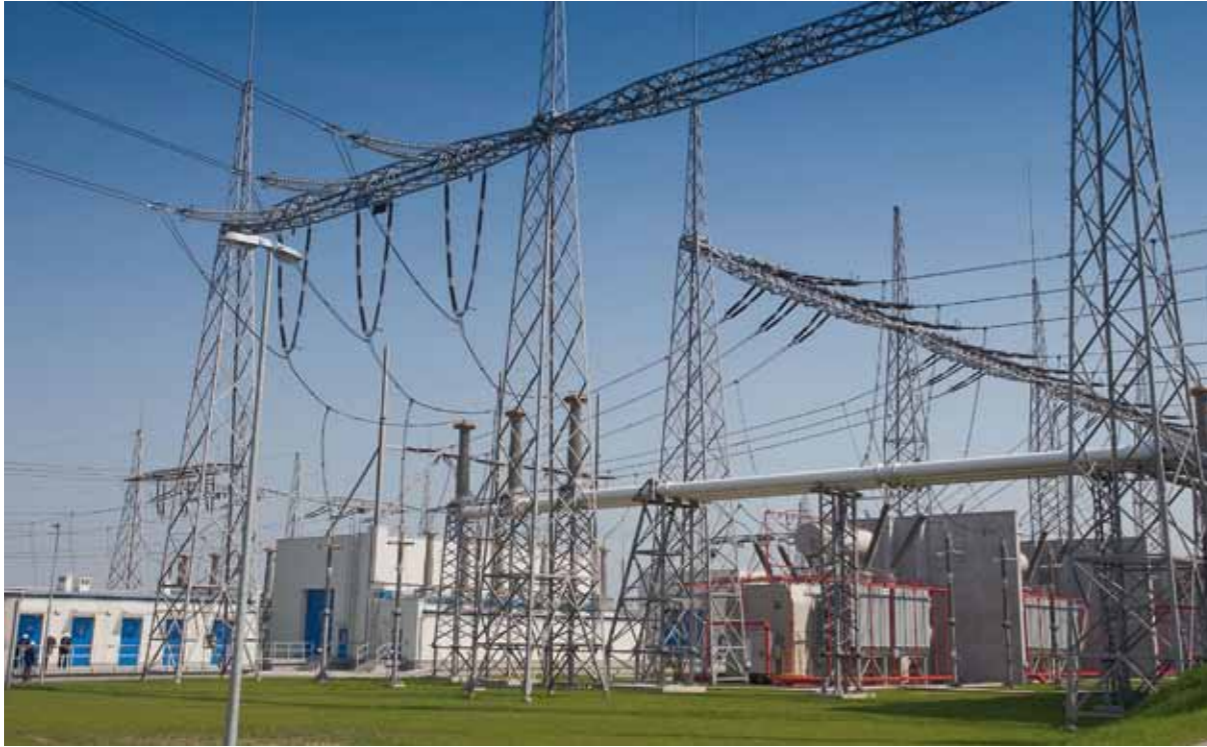
Rysunek 12. Stacja elektroenergetyczna 400/220/110 kV Oltarzew.
