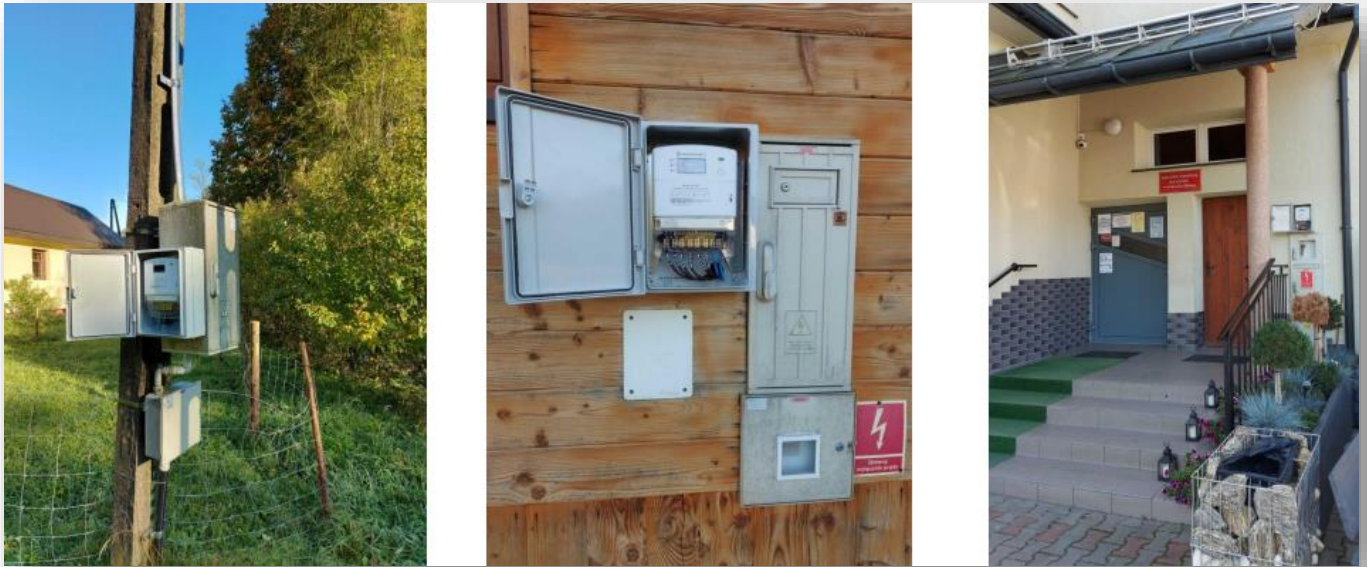
Rys. 70 Instalacje w dodatkowych skrzynkach licznikowych na słupach, elewacjach budynków 122
