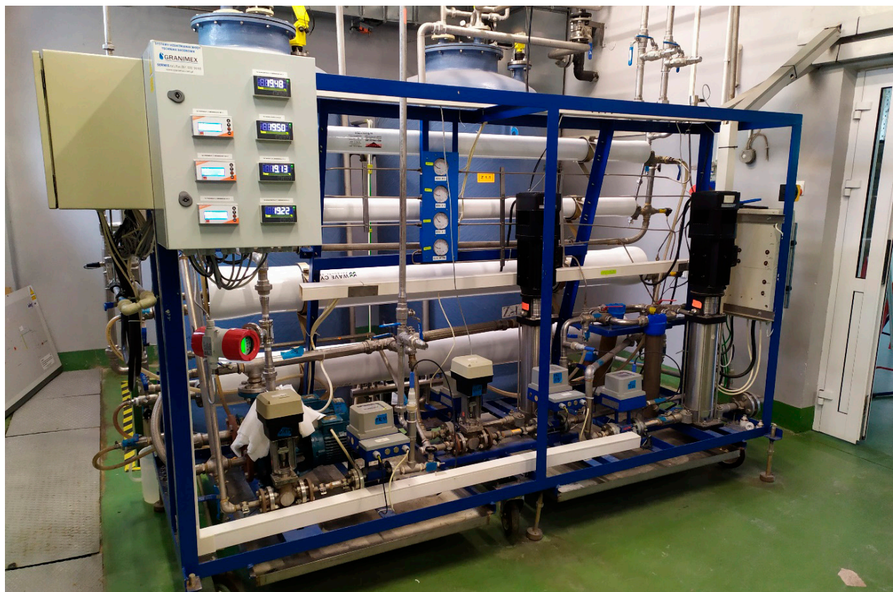
Fot. 3. Instalacja odwróconej osmozy po modernizacji w 2020 r. (fot. KSOP) Photo 3. Reverse osmosis installation after modernization in 2020
