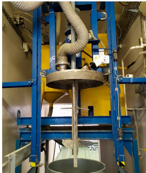
Fot. 7. Mieszadło wraz z zintegrowanym systemem dozowania cementu oraz zatężonych ciekłych odpadów Photo 7. Agitator with integrated cement and concentrated liquid waste dosing system
