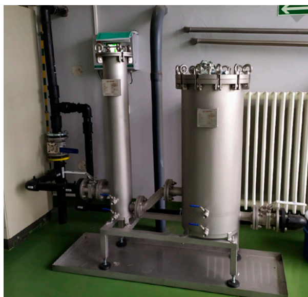
Fot. 2. Bateria filtracyjna (fot. KSOP) Photo 2. Filters battery
