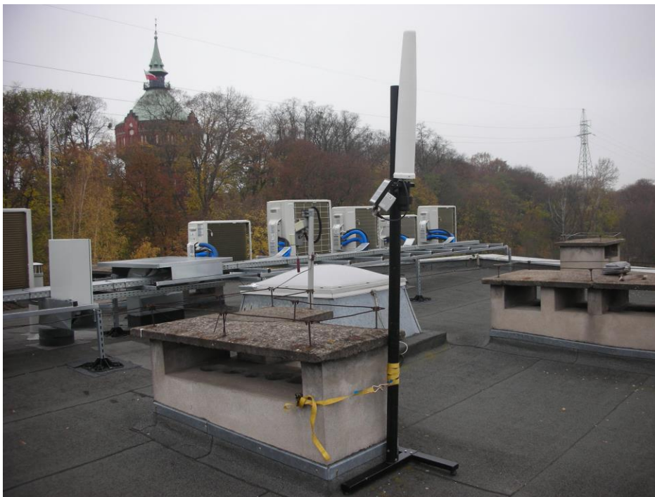
Rys. 2 Miejsce montażu pilotażowego SMS PEM – UM Bydgoszcz
