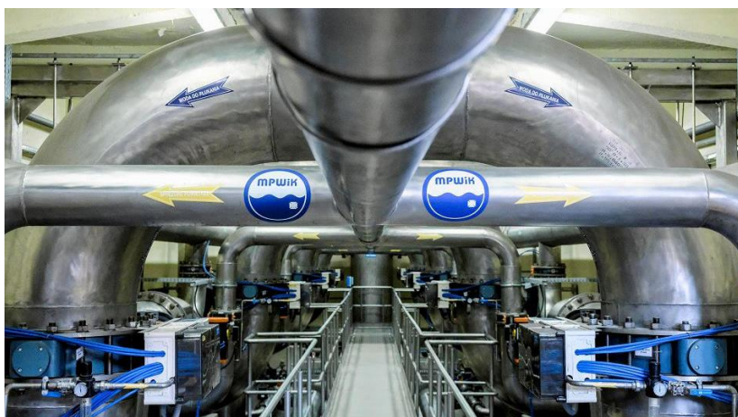
Fot. 3. Elementy instalacji w stacji uzdatniania wody należącego do MPWiK w Rzeszowie.
