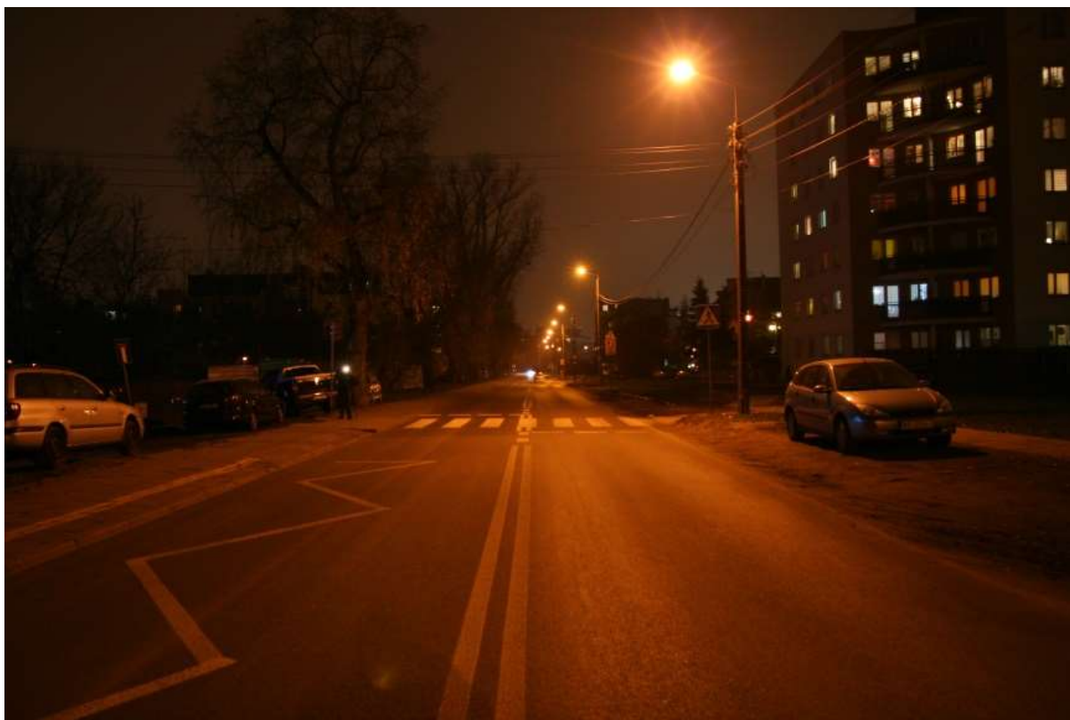
Rys. Z.8.1. Widok instalacji oświetleniowej – przykład 1
