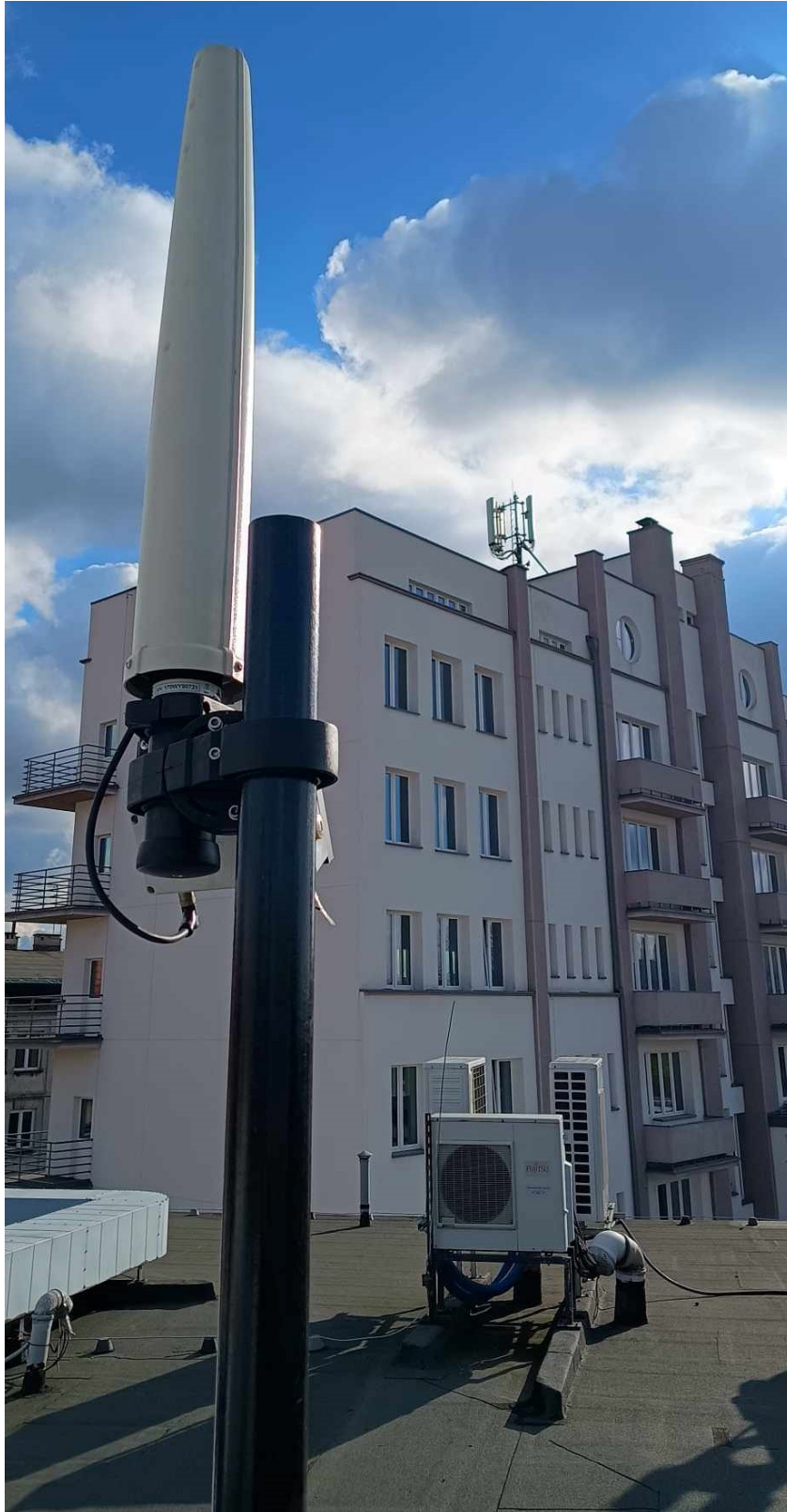
Rys. 2 Miejsce montażu SMS PEM – USC w Katowicach – widok na SBTK
