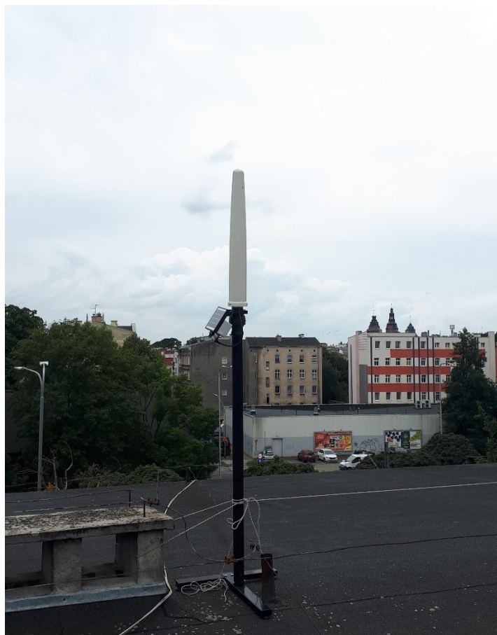
Rys. 2 Miejsce montażu SMS PEM – Szkoła Podstawowa nr 11 w Szczecinie
