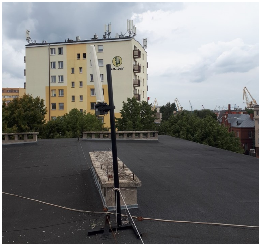
Rys. 3 Miejsce montażu SMS PEM – Szkoła Podstawowa nr 11 w Szczecinie – widok na SBTk
