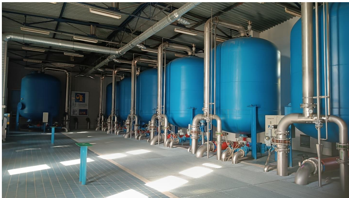
Zdjęcie nr 1: Hala filtrów – Stacja Uzdatniania Wody Strzyżewice.
