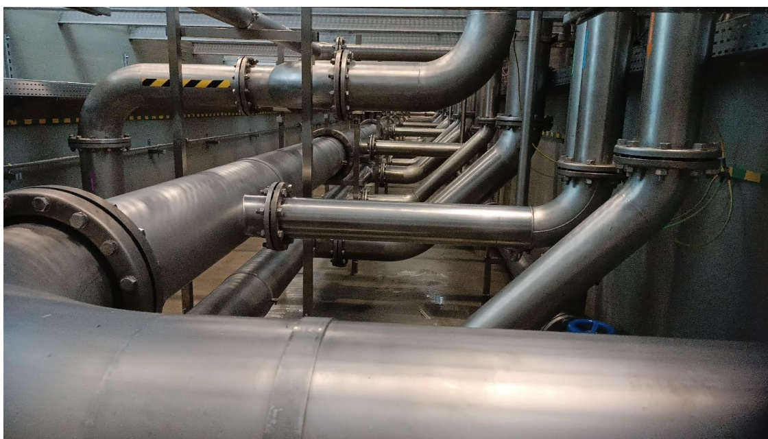
Zdjęcie nr 2: Galeria rurociągów – Stacja Uzdatniania Wody Strzyżewice.
