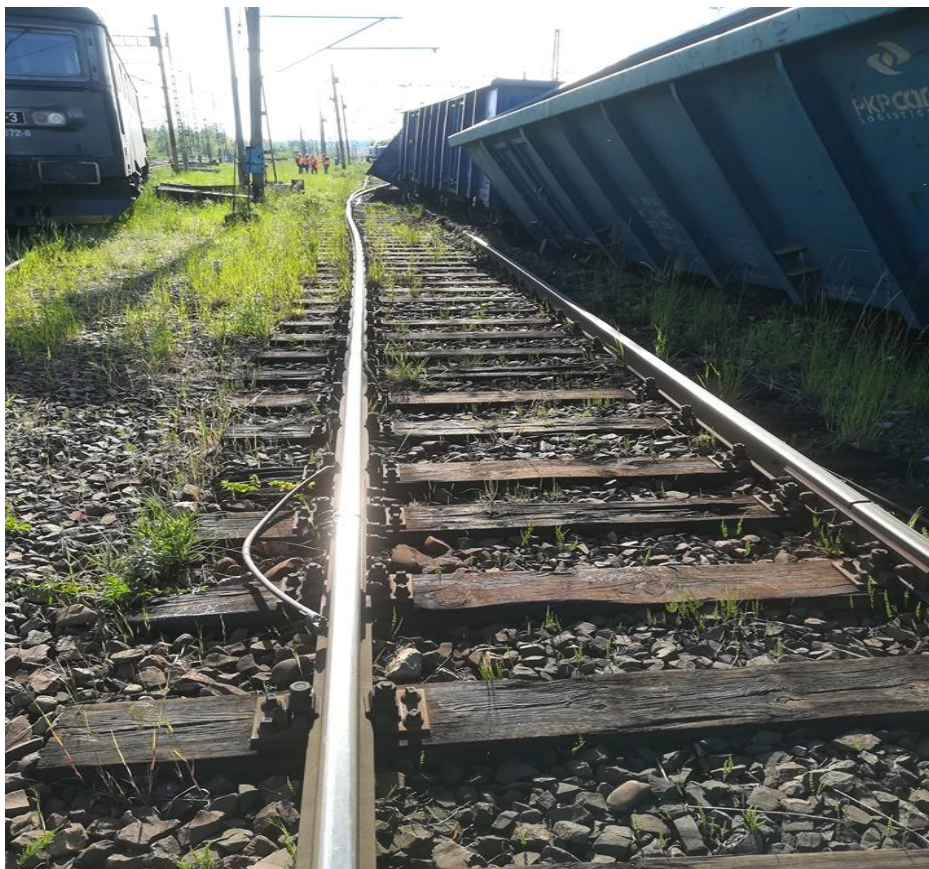
Zdjęcie 3 - Uszkodzony rozjazd nr 455 przez wykolejenie się wagonów składu pchanego przez lok SM42-1205
