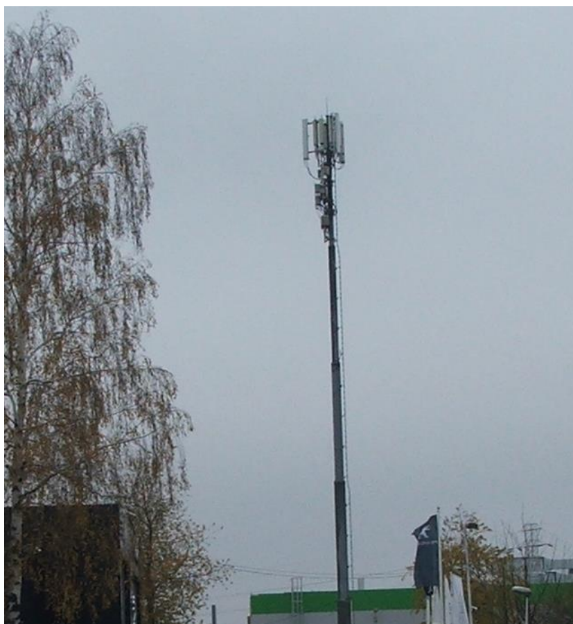
Fot. 1: Widok anten stacji bazowej ID: LOD1103_B, zlokalizowanej pod adresem: ul. Snowalniająca 3, 92-340 Łódź
