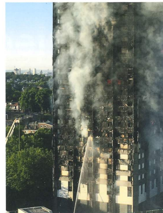
Ogień rozprzestrzenił się po elewacji budynku ocieplonego materiałem o niedostatecznej ogniotrwałości fot. Natalie Oxford / Wikipedia (CC BY 4.0)
