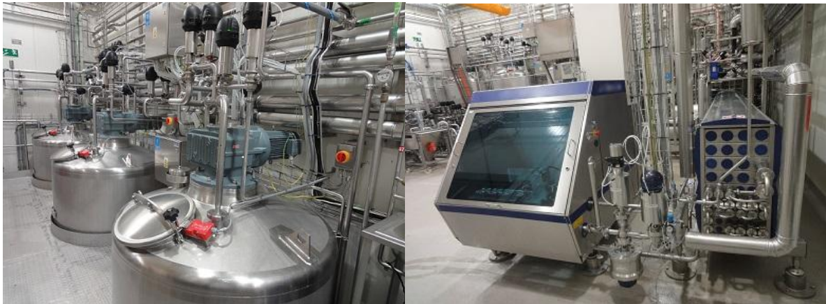
Rys. 2. Linia do napełniania tubek (saszetek z nakrętką) oraz układ pasteryzacji.
