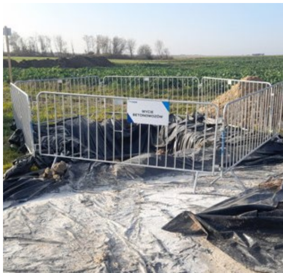
Przykład organizacji miejsca do mycia betonowozów
