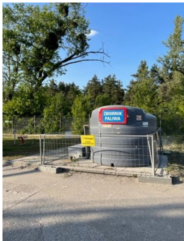
Miejsce do tankowania paliwa z uszczelnionym podłożem oraz sorbentem na wypadek wycieku
