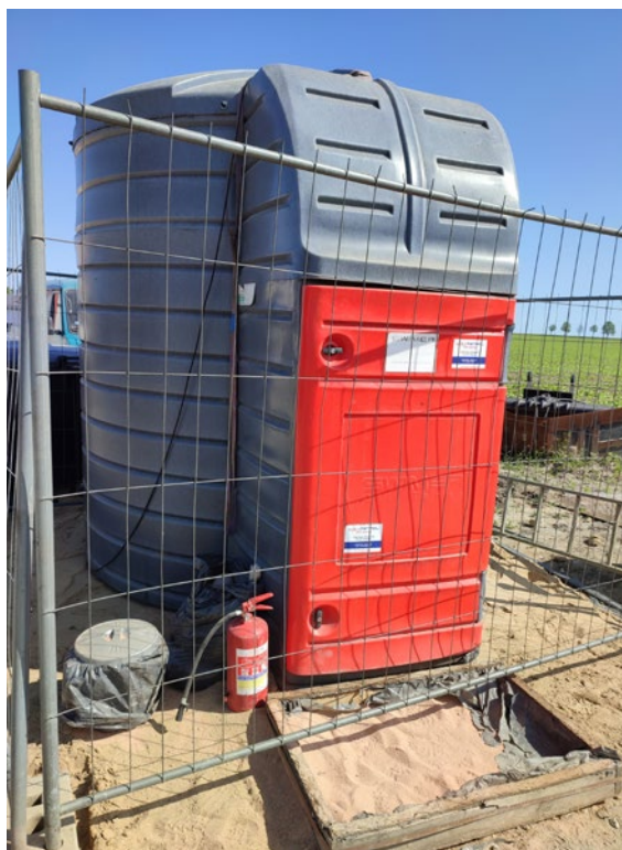
Miejsce do tankowania paliwa z uszczelnionym podłożem oraz sorbentem na wypadek wycieku
