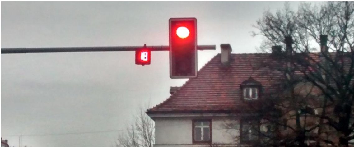
Rys. 15.22. Wyświetlacz czasu zamontowany na wysięgniku obok sygnalizatora S-1 na skrzyżowaniu ulic De Gaulle'a i Roosevelta w Zabrze; źródło: (opracowanie zespołu badawczego, 2015)
