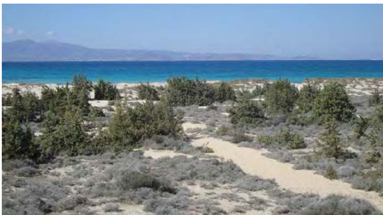
W projekcie Junicoast zainstalowano ogrodzenia stabilizujące piasek na nieporośniętych wydmach podlegających ostrej erozji wiatrowej na greckiej wyspie Chrysi
