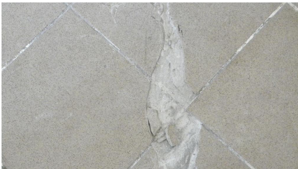
Zdjęcie 6: uszkodzone powierzchnie podłóg w magazynie piekarni – autor Jagoda Jurga
