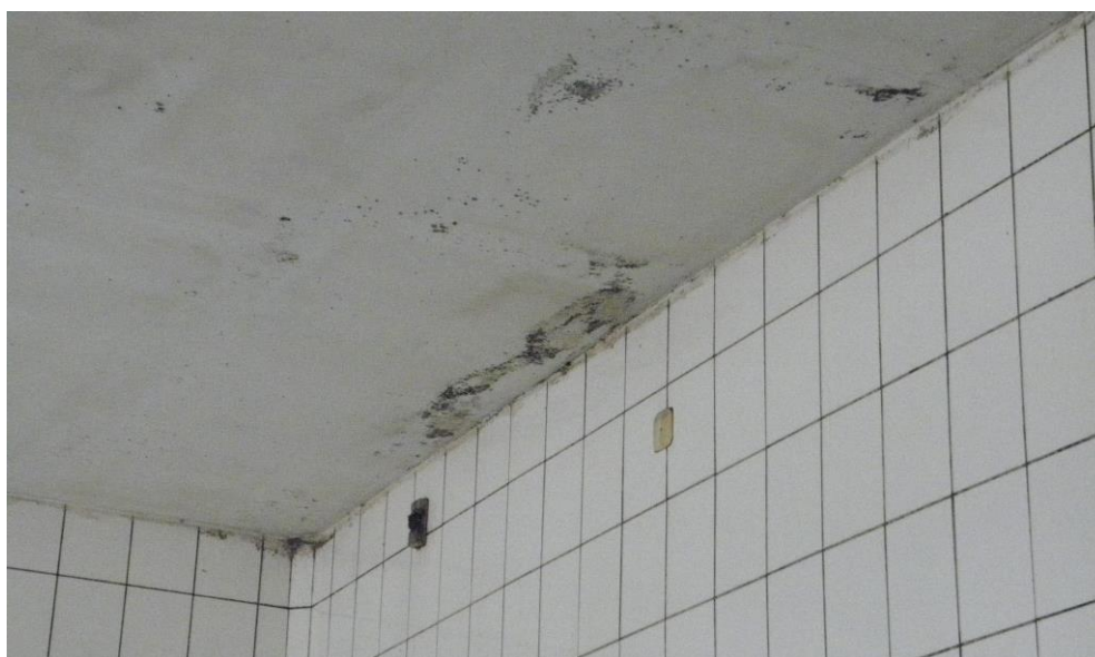
Zdjęcie 5: wykwity pleśni i wilgoci w pomieszczeniu produkcyjnym piekarni – autor Jagoda Jurga
