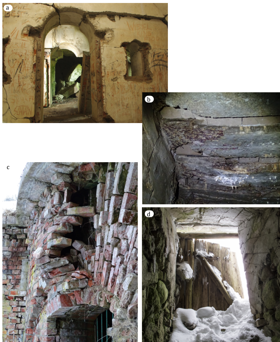
Ryc. 30. Przykłady uszkodzeń w obiektach wykorzystywanych przez mopki zachodnie jako zimowiska: (a) spękania ścian fortu (fot. Iwona i Tomasz Gottfried), (b) pękające belki stropu piwnicy, (c) spękania wokół wejść do fortyfikacji (fot. Maciej Fuszara), (d) uszkodzone drzwi do piwniczki (fot. Grzegorz Błachowski)
