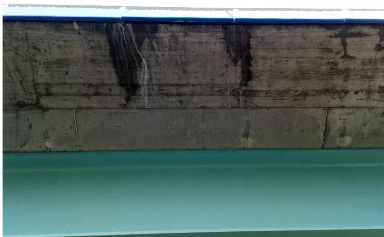
Rys. 6-9. Zacieki na powierzchni wsporników podchodnikowych przęsła stalowo-betonowego
