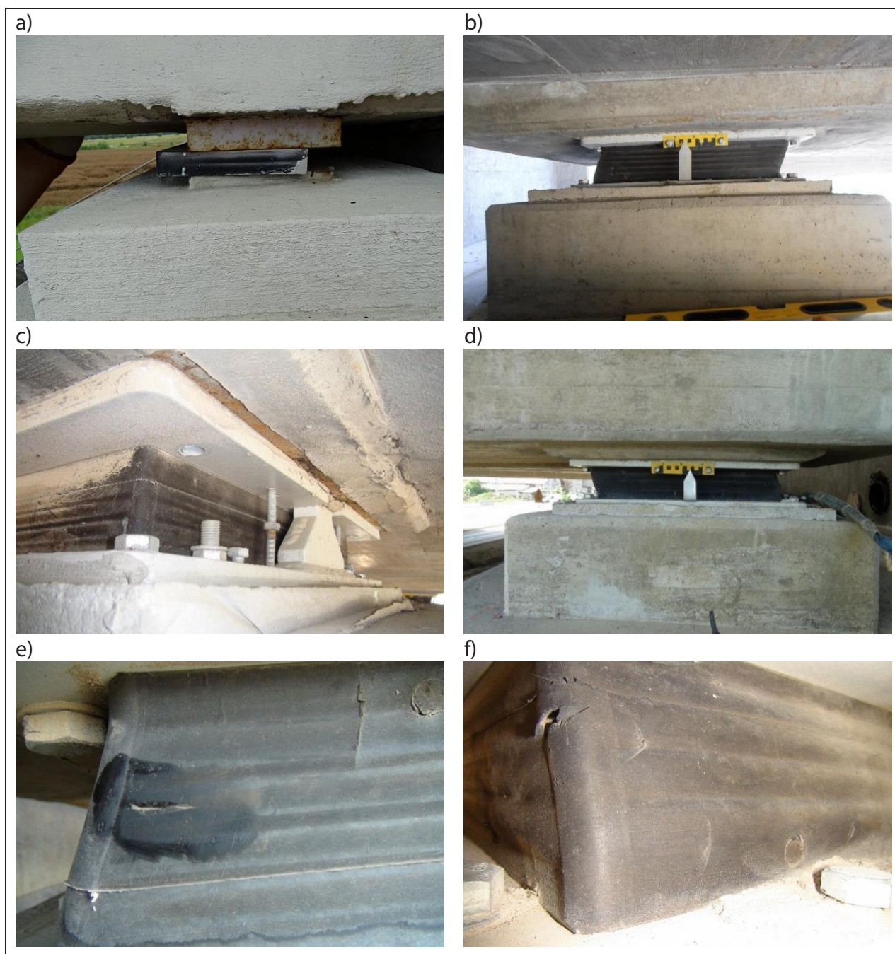
Rys. 6-14. Wybrane, typowe uszkodzenia łożysk elastomerowych: a) wysunięcie płyty elastomerowej, b) przekroczenie zakresu przesuwu w łożyskach, c) ścięcie zakotwień płyty górnej łożyska stałego do dźwigara, d) nadmierna deformacja, e,f) pęknięcie elastomeru w łożyskach
