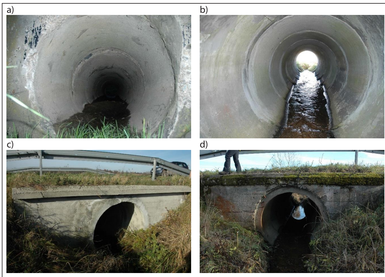
Rys. 6-1. Wybrane typowe uszkodzenia przepustów: a) ubytki betonu w rurowych prefabrykowanych elementach przepustu, b) przemieszczenia prefabrykowanych elementów przepustu, c) zacieki i wykwyty na głowicy wlotowej przepustu, d) wegetacja (mech) na gzymsie przepustu
