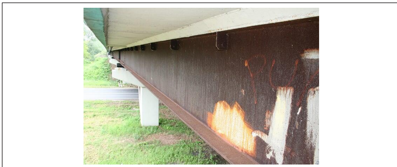
Rys. 6-10. Korozja stalowego dźwigara w przęśle o konstrukcji zespolonej stalowo-betonowej
