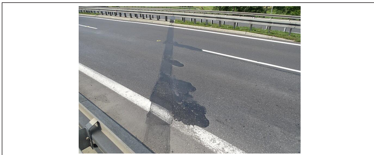
Rys. 6-16. Uszkodzenia bitumicznego przykrycia dylatacyjnego spowodowane niską jakością materiału i wykonawstwa
