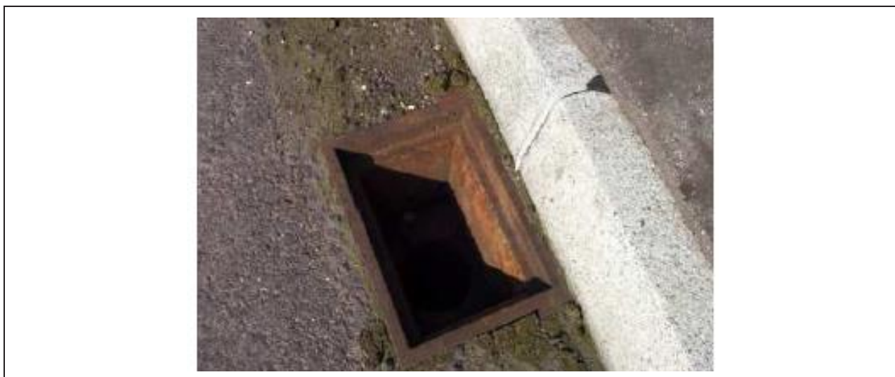
Rys. 6-19. Brak wpustu, prawdopodobnie spowodowany jego kradzieżą
