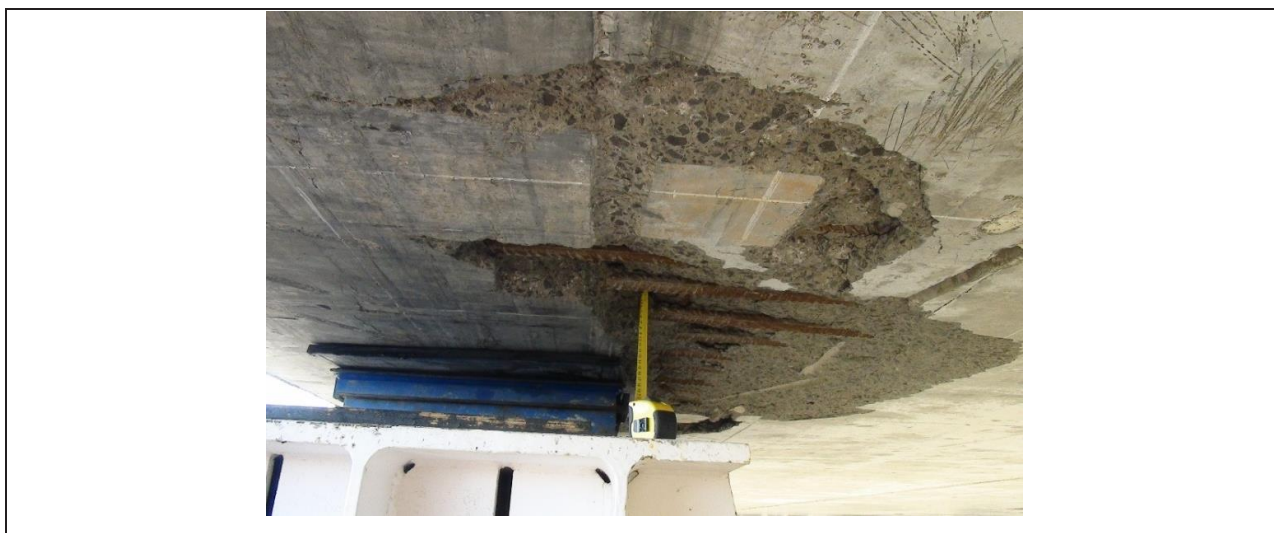
Rys. 6-5. Ubytki betonu, odsłonięte zbrojenie i kable sprężające spowodowane błędami wykonawczymi
