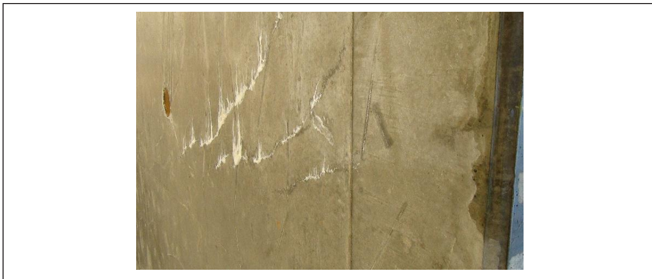
Rys. 6-3. Rysy w monolitycznym przęśle betonowym; w miejscu zarysowania występują przecieki i w ich efekcie wykwyty na powierzchni betonu
