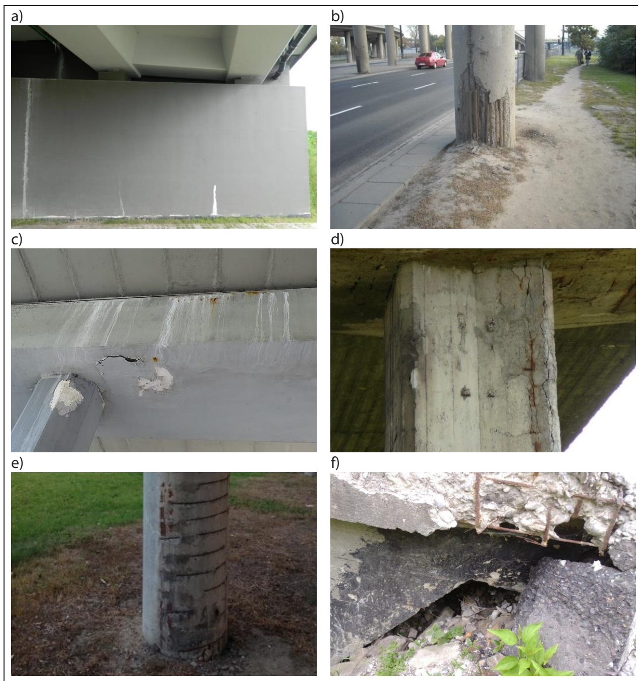
Rys. 6-13. Wybrane, typowe uszkodzenia betonowych podpór mostowych: a) rysy pionowe w szerokich przyczółkach masywnych powstałe na etapie budowy wskutek braku swobody odkształceń korpusu wykonanego na wcześniej zabetonowanym fundamencie, b) znaczne ubytki materiału podpór (filarów) spowodowane korozją zbrojenia, c) zaciek, wykwit, korozja betonu i zbrojenia oczepów podpór, d) rysy, spękania, korozja zbrojenia słupa podpory, e) odsłonięte skorodowane zbrojenie filara (przyczyną uszkodzeń jest zbyt mała otulina zbrojenia), f) odsłonięte skrzydło, korozja zbrojenia, ubytki betonu
