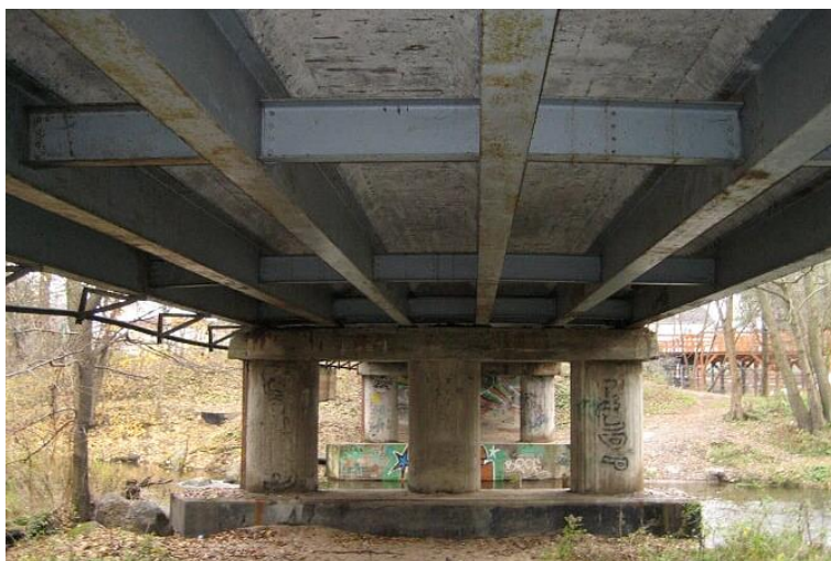
Rys. 6-8. Typowe uszkodzenia przęsła stalowo-betonowego; przecieki, wykwyty, ubytki betonu, korozja zbrojenia w płycie pomostu oraz uszkodzenia powłoki ochronnej i korozja stalowych dźwigarów i poprzecznic
