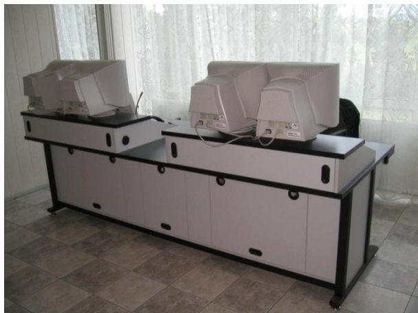
Fotografia nr 4.5. Pulpit stanowiska dyspozytorskiego. 131
