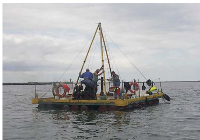
Fig. 7.33. Platforma wiertnicza WW-UNIGEO podczas prac geologiczno-inżynierskich pod budowę Głębokowodnego Terminalu Kontenerowego DCT w Gdańsku
