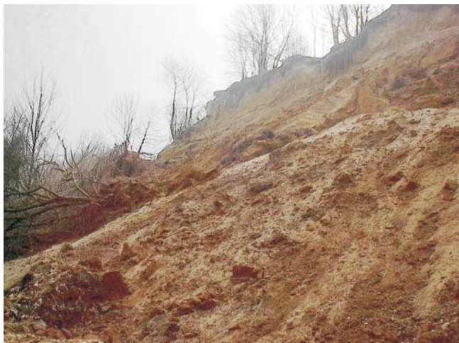
Rys. 10.42. Osuwisko w Rozewiu, 3.12.2005 r.
