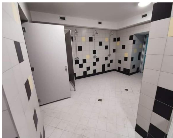
Zdjęcie: Natryski na pływalni (Pływalnia Miejska ul. Śniadeckiego)
