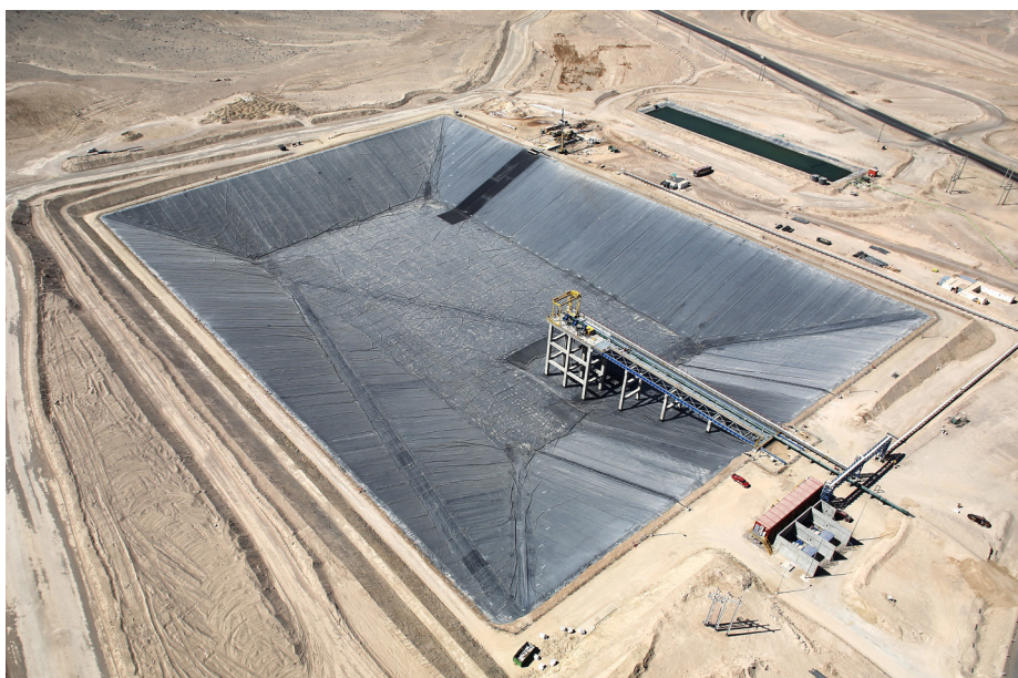
Zdjęcie nr 6 Zbiornik wody morskiej w SG
