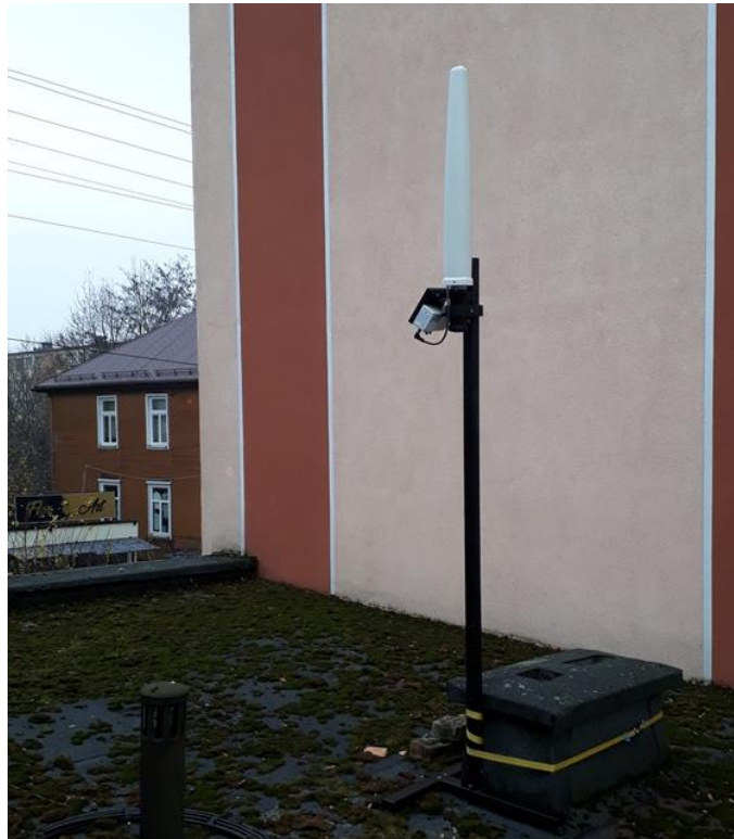
Rys. 2 Miejsce montażu SMS PEM – UM Białystok
